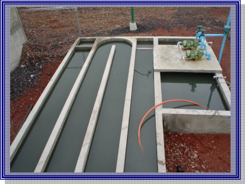
PLANTA DE TRATAMIENTO DE AGUAS RESIDUALES
