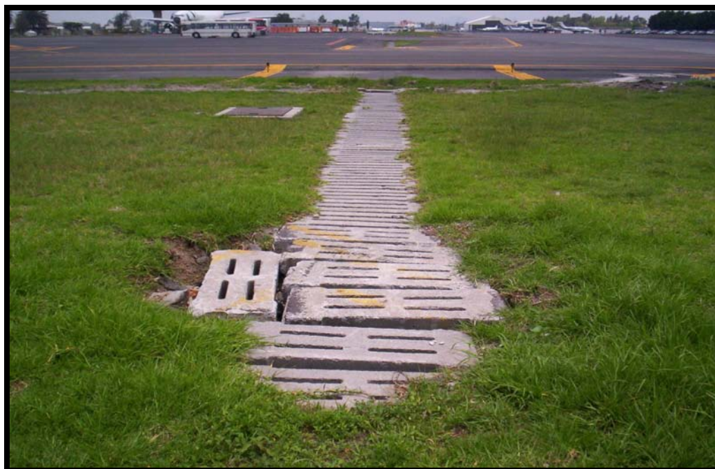
Trinchera con tapas de concreto hidráulico en mal estado.
