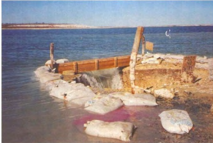
Figura 73. Presa “La Amistad”, sumidero 1, formado en 1994 (Hungsberg, 2001).
