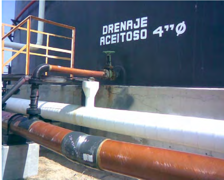
Fig.6.6. Drenaje Aceitoso (válvula y colector del mismo).
