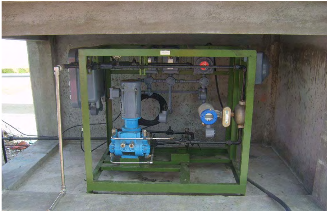
Fig. 6.8 Patín dosificador con bomba.
