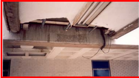
PLAFONES EN MAL ESTADO
