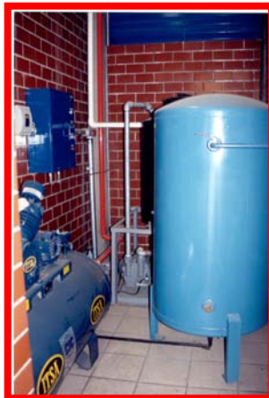
CUARTO DE MAQUINAS (FES - ACATLAN)
