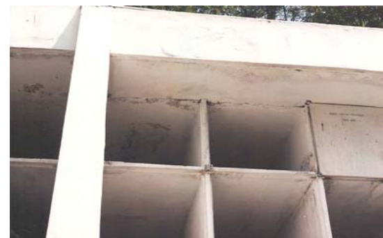
Gavetas que presentan humedad.
