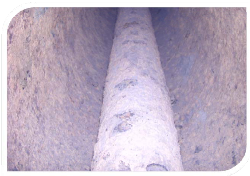
Figura 27.- Corrosión Impregnada en el Pozo
