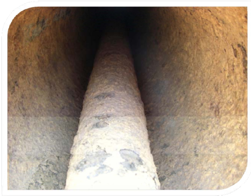
Figura 26.- Corrosión del Ademe
