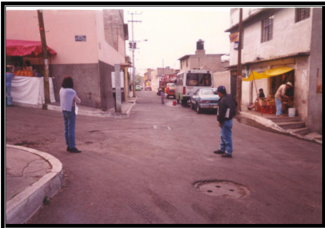
Fotografía No. 4 Trazo de la línea del proyecto sobre la calle Tenochtitlan vista desde la calle Benito Juárez
