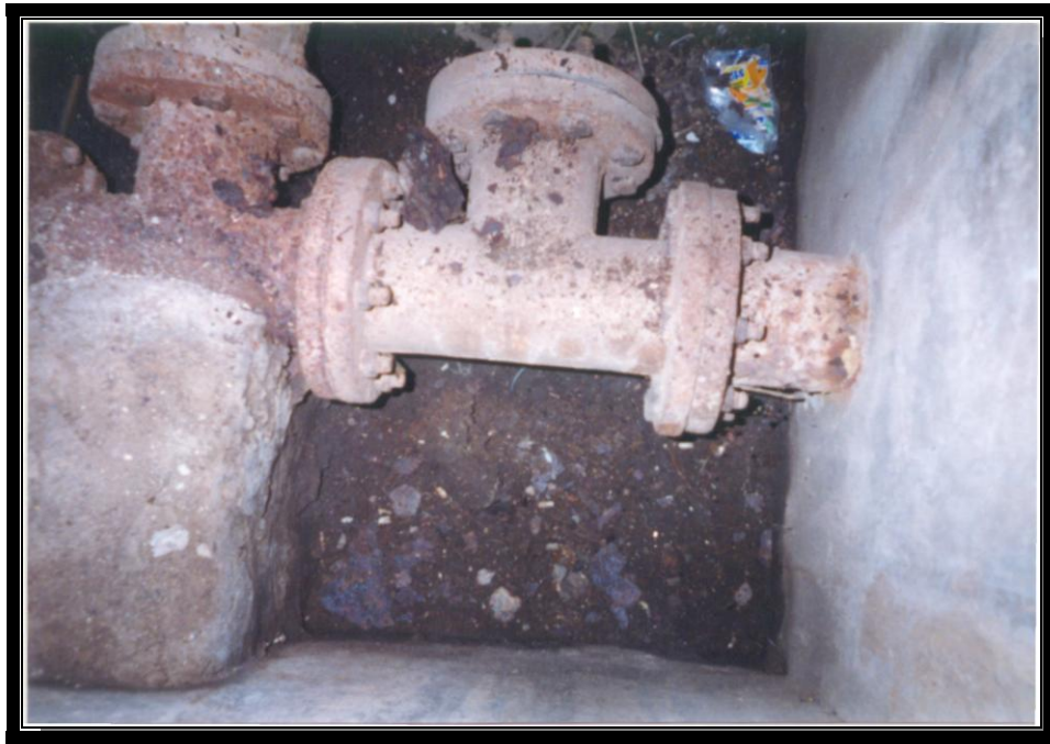
Fotografía No. 11 Interior de la caja de agua potable de 4" de diámetro ubicada en privada Xicotencatl y calle Xicotencatl
