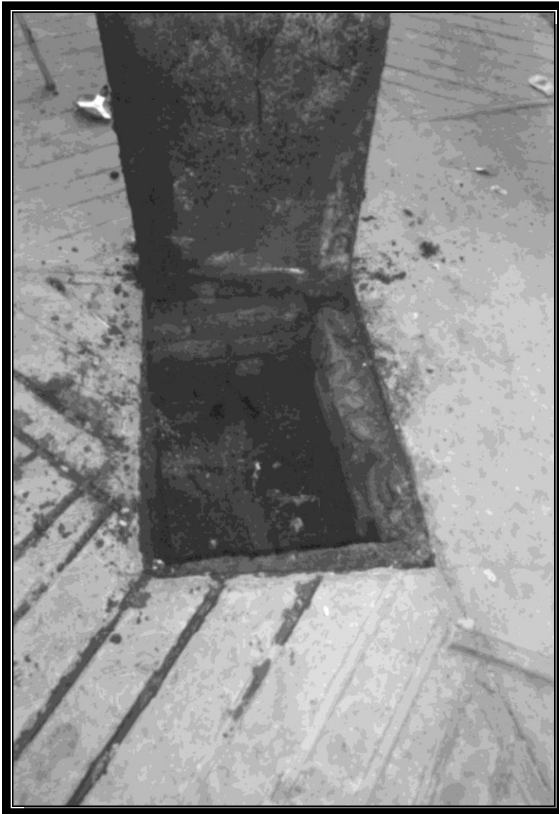
Fotografía No.13. Caja de válvula de agua potable (azolvada) sobre la calle Xicotencatl y Xochitla
