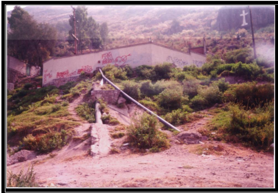
Fotografía No. 9 Vista del tanque GM-8
