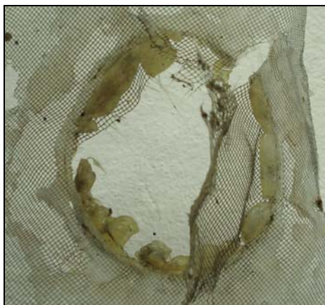
Figura 4.3. Fotografía de la malla dañada
