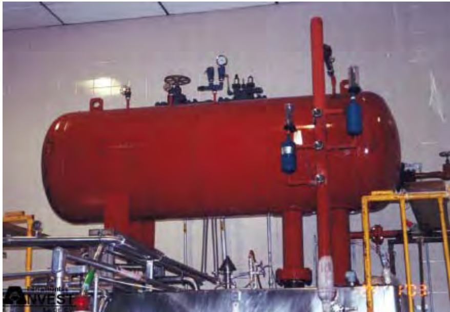
Figura 3.3.2. Acumulador de agua caliente sanitaria.
