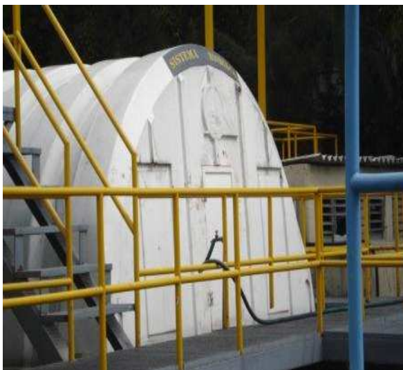
Figura 2.19 Sistema de Biodiscos de tratamiento de aguas residuales en C.U.
