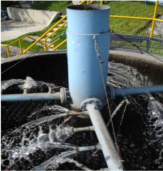
Figura 2.17 Sistema Rociador de la planta de tratamiento de aguas residuales en C.U.
