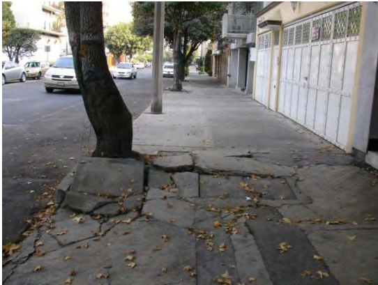
Banqueta de la esquina entre Calle Miguel Laurent y Calle Moras de la Delegación Benito Juárez
