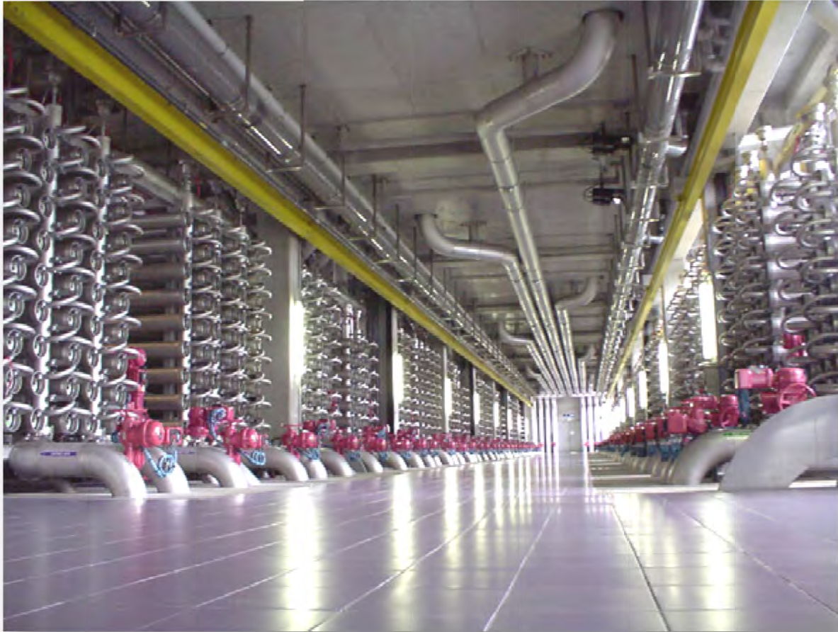
Figura 4.7. Pasillo de la planta en donde se pueden ver claramente los tubos de presión que contienen a las membranas de nanofiltración. Tomada de http://www.veoliawater.com
