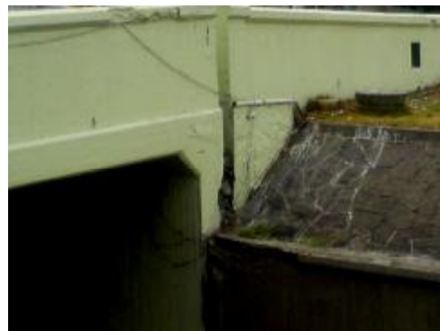
Figura 2.8 Av. Monterrey y Viaducto Miguel Alemán
