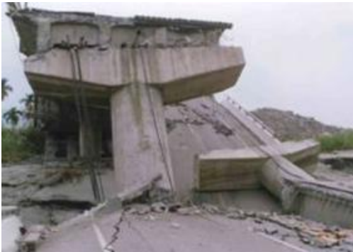
(a) Pérdida de apoyo de los vanos del Puente Mingchou
