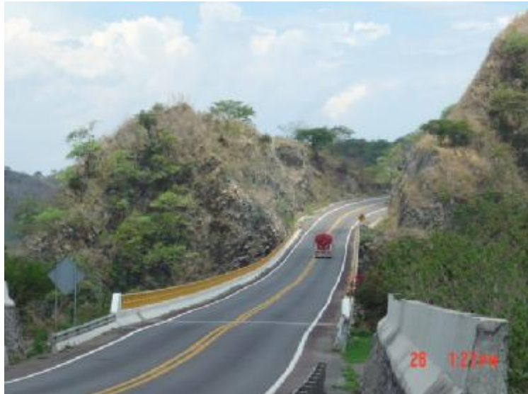
Figura 1.5 Deformaciones en los terraplenes de acceso
