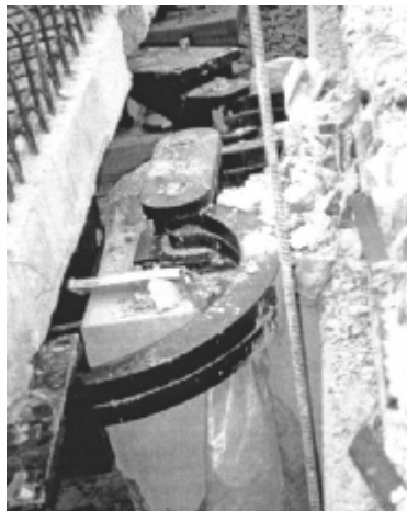
Figura 1.83 Falla de las conexiones de los disipadores metálicos en una junta de expansión
