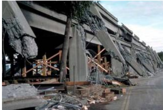
Figura 1.74 Falla del Viaducto Ciprés, en una longitud próxima a 1.5 km (Nakata et al., 1999).
