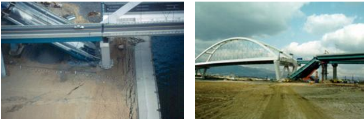
Figura 1.78 Daños en la vía rápida Wangan (EQE, 1995)
