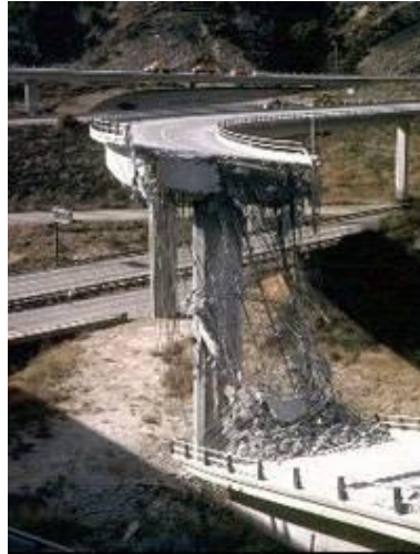
Figura 1.75 Derrumbe de los claros del conector norte de la ruta estatal I4/I5 (EQE, 1994)
