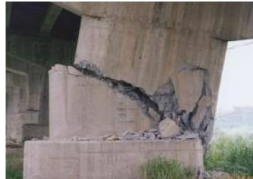
(b) Falla a cortante de una pila del Puente U-Shi
