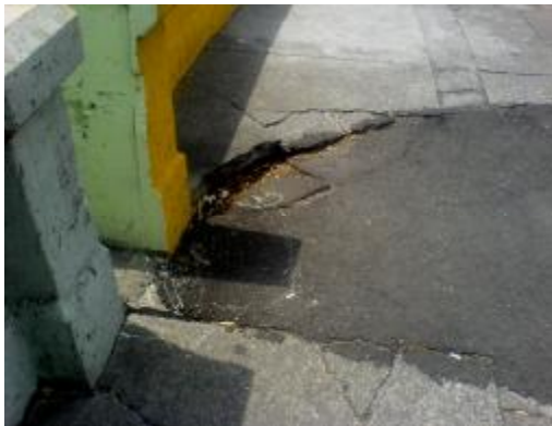
Figura 2.21 Av. Monterrey y Viaducto Miguel Alemán
