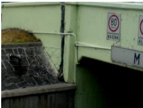
Figura 2.7 Av. Monterrey y Viaducto Miguel Alemán
