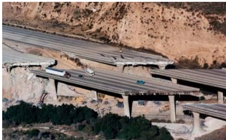
Figura 1.76 Fase del proceso de demolición del paso a desnivel Gavin Canyon (EQE, 1994)
