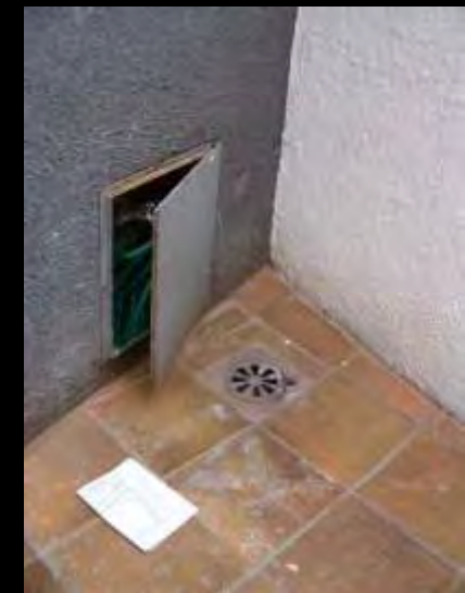
COLADERAS Y REGISTROS
