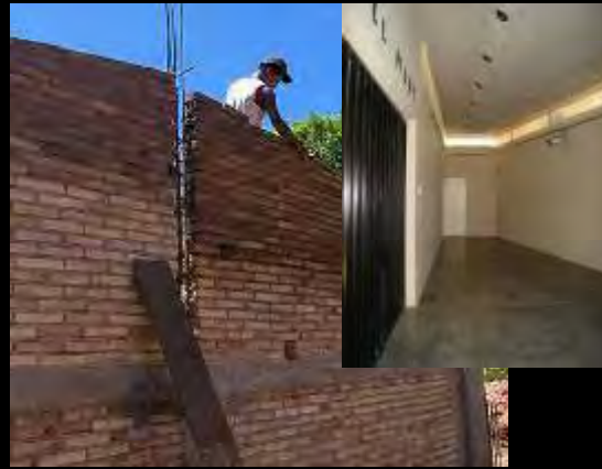
TABIQUE ROJO EN MUROS INTERIORES.
