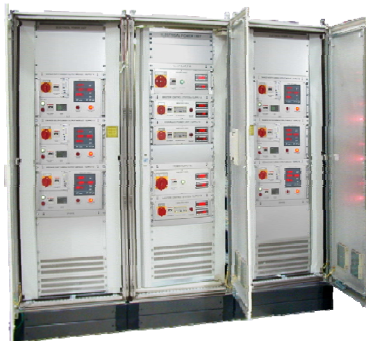
FIG. II.26 Unidad de Potencia Eléctrica Propiedad CAMERON
