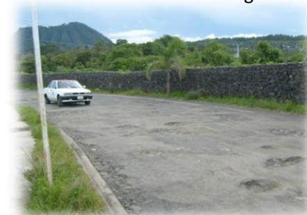
Interrupción de la filtración del agua pluvial por los pavimentos de concreto
