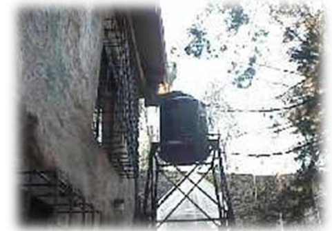
Captación y almacenaje de agua pluvial
