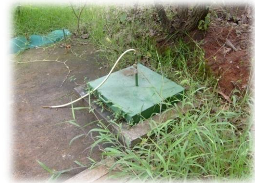
Planta captora de gas
