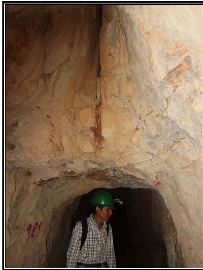
Fotografía 4.12 Falla de desplazamiento lateral en mina Los Murciélagos
