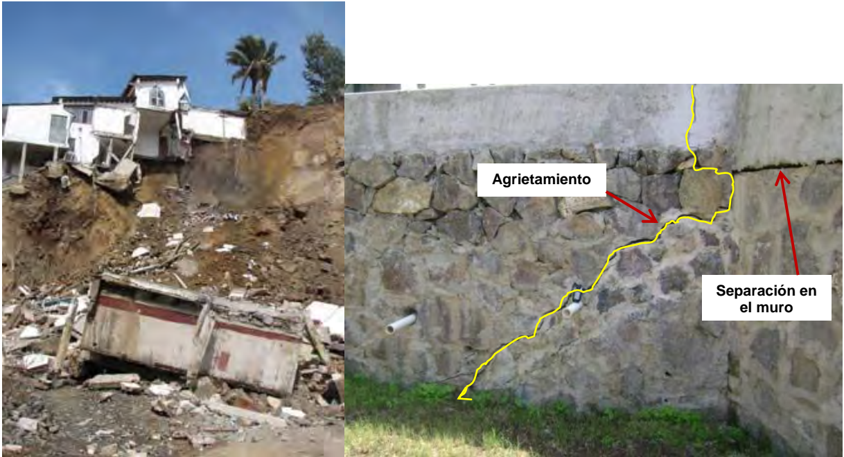
Figura 26. En la imagen de la izquierda se muestra un deslizamiento rotacional que ocurrió en residencial Villas de la Colina II en el 2007. A la derecha se muestra una fotografía tomada en octubre de 2008 de un muro bajo una terraza la cual presenta agrietamientos por el desplazamiento del talud, este también se encuentra en residencial Villas de la Colina II lo que hace pensar en que de nuevo se está presentando el fenómeno deslizamiento rotacional.
