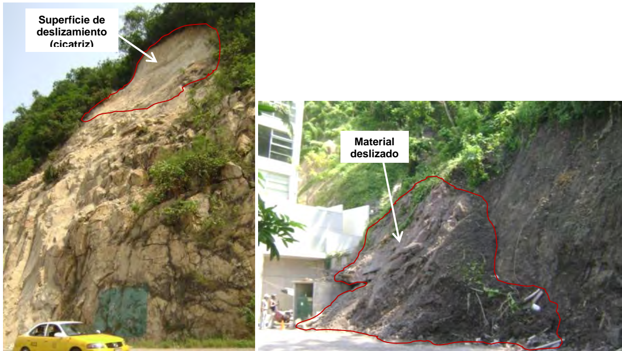
Figura 25. Deslizamientos (traslacionales) de roca. En la imagen de la izquierda se presenta la cicatriz de un deslizamiento de rocas en la carretera federal 200, este deslizamiento se presentó sobre granitos. En la imagen de la derecha se muestra un deslizamiento sobre andesitas muy fracturadas que presentaban arcillas dentro de diaclasas. El deslizamiento pudo ser causado por las modificaciones a la pendiente por la construcción de un edificio de departamentos el cual se puede observar a la izquierda de la imagen.
