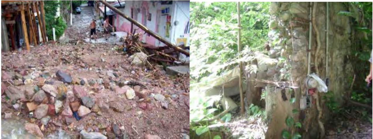
Figura 35. En la imagen de la izquierda (Noticiaspv.com, 2007) se puede observar el material que fue arrastrado por el flujo. En la imagen de la derecha se muestra parte de la casa que fue destruida por el flujo de detritos.
