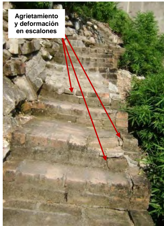
Figura 28. La imagen de la izquierda muestra una serie de escalones que presentan deformación debido a desplazamientos en el andador Olas Altas.
