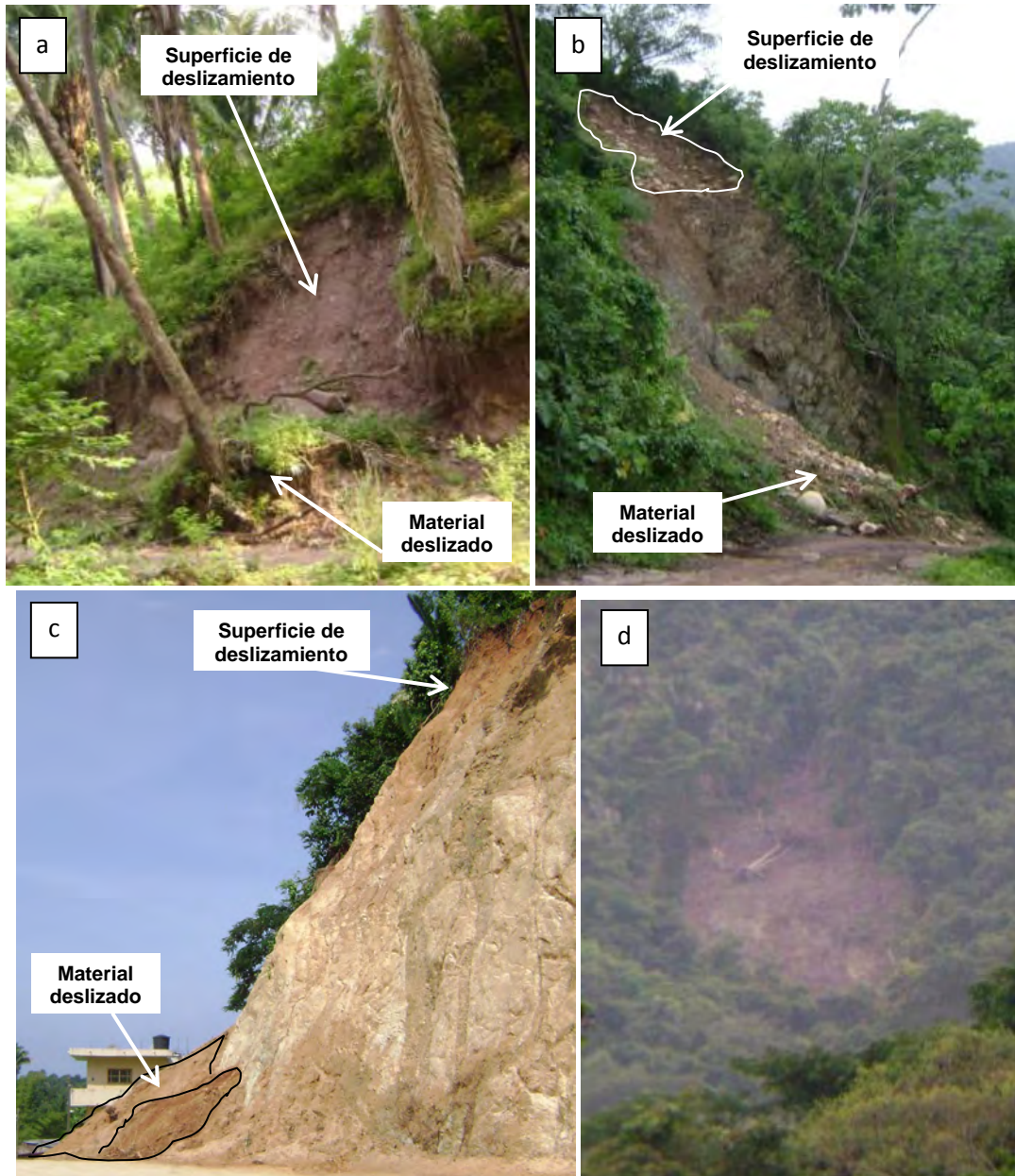
Figura 24. Deslizamientos superficiales (detritos). (a) Deslizamiento de suelo y detritos sobre andesitas, causado por el debilitamiento de la base de la pendiente debido a la construcción de un camino en un cerro contigua a la comunidad de Playa Grande. (b) Deslizamiento de suelo y detritos sobre andesitas en camino hacia la población de Paso Ancho, que se puede catalogar como remóntate ya que es causado por la pérdida de su base posiblemente por un deslizamiento anterior. (c) Deslizamiento de suelo sobre granito en Mismaloya, aquí el material que se desliza contiene pocos fragmentos de roca en comparación de lo que se presenta en andesitas. (d) Deslizamiento ocurrido en condiciones naturales dentro del cañón del río Cuale, donde aparentemente no existió alguna intervención antrópica, lo que puede indicar que no es necesaria una modificación de las condiciones naturales para que se presente un deslizamiento en la zona.
