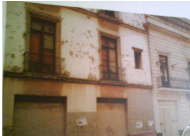
F-44, F-45 La fachada principal, y el interior del edificio se encontraban en pésimas condiciones, como se observa en las imágenes. En la primera etapa del proyecto de restauración se hizo una evaluación exhaustiva del estado de construcción al momento de iniciar el proyecto.
