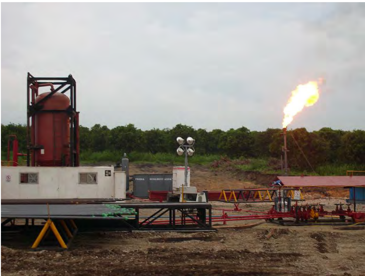
Figura 3.17 Quemador para perforación bajo balance
