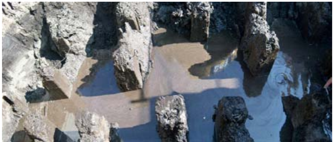
Inundación de zapatas debido a lluvias o a tuberías de drenaje que se fracturaban en el momento de los trabajos
