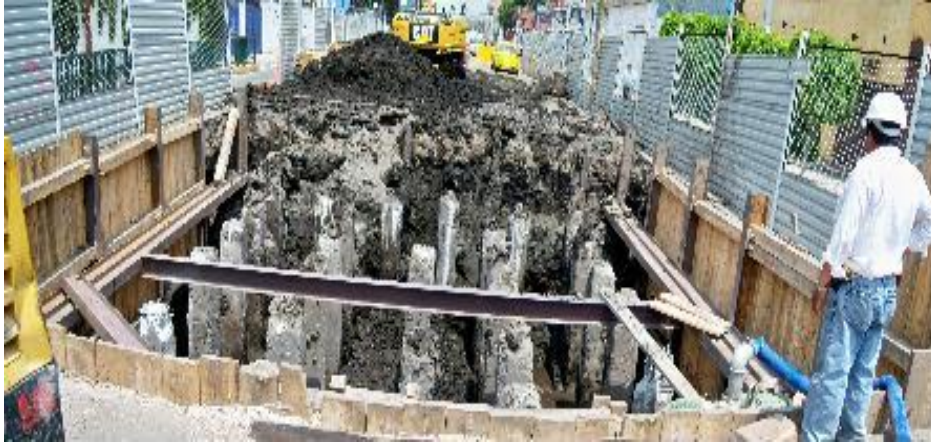
Ya se colocó el Muro Berlín en tres caras de la zapata
