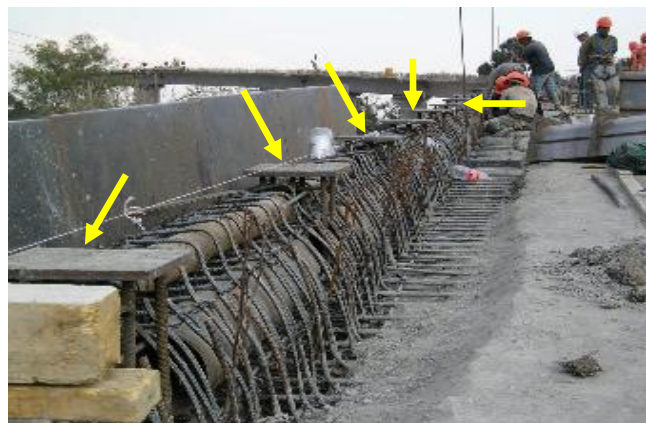
Las placas base van colocadas a una distribución de 2m de separación entre cada una de ellas en todo lo largo
