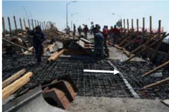
Tubería de PVC flexible de 51mm para alumbrado bajo puente
