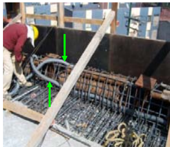
Tubería eléctrica para alumbrado sobre puente
