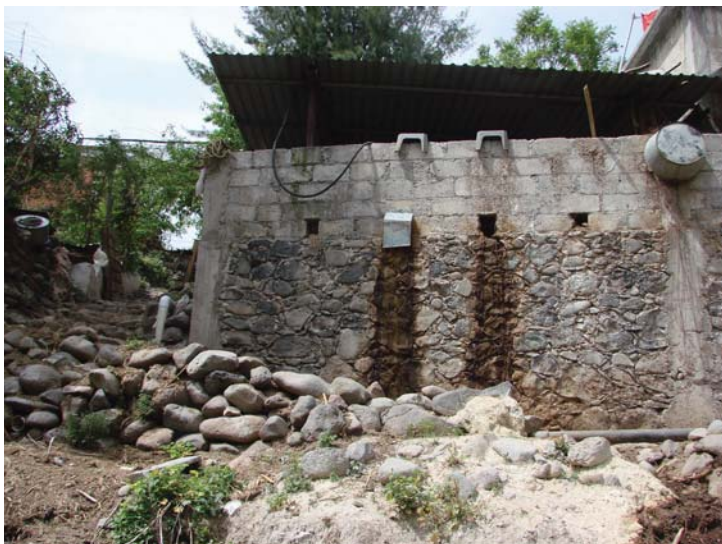
Figura 8.9.3 Falta de alcantarillado.
