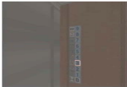
Fig. 5 Ascensor en paro de emergencia
