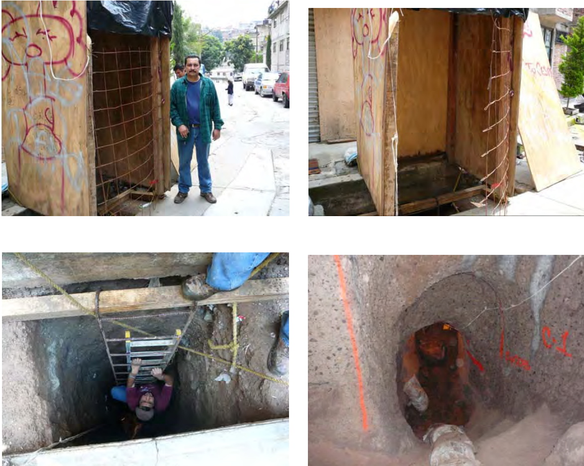
Figura 5.17 Fotografías del aspecto exterior de la lumbrera de sección rectangular la cual se utilizó para tener acceso al túnel.
