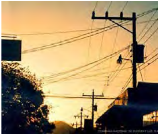
Figura. 5.5 Líneas de distribución.
