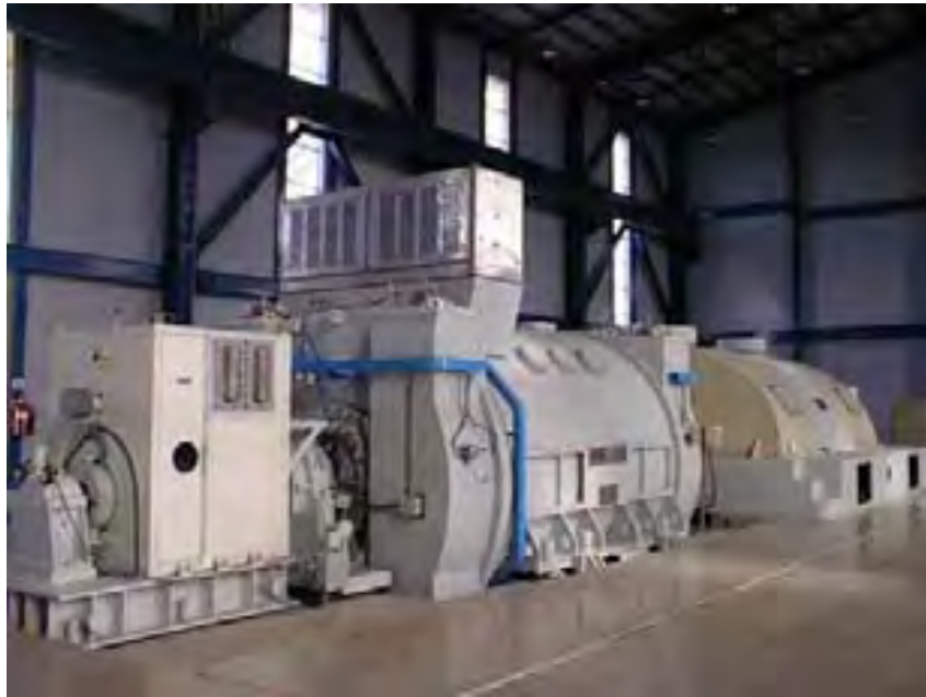
Figura. 5.11 Generador de energía eléctrica.
