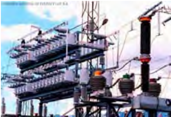
Figura. 6.5 Banco de capacitores.
