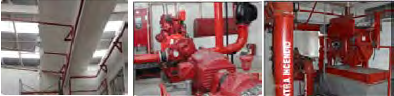
Figura. 3.32 Instalaciones contra incendio dentro de una planta.
