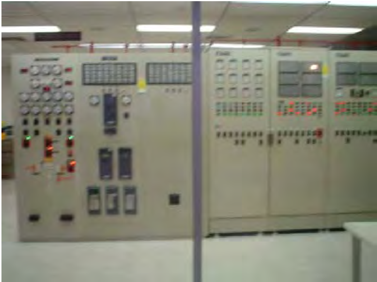
Figura. 3.53 Tableros de Control de la planta hidroeléctrica “agua prieta”, Jalisco.
