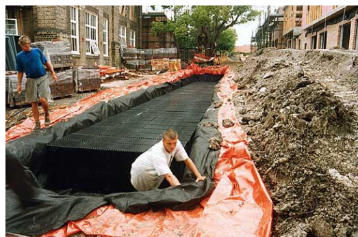
Fig.07. Depósitos impermeabilizados: Acumulan y retienen el agua para su posterior reutilización mediante bombeo.
