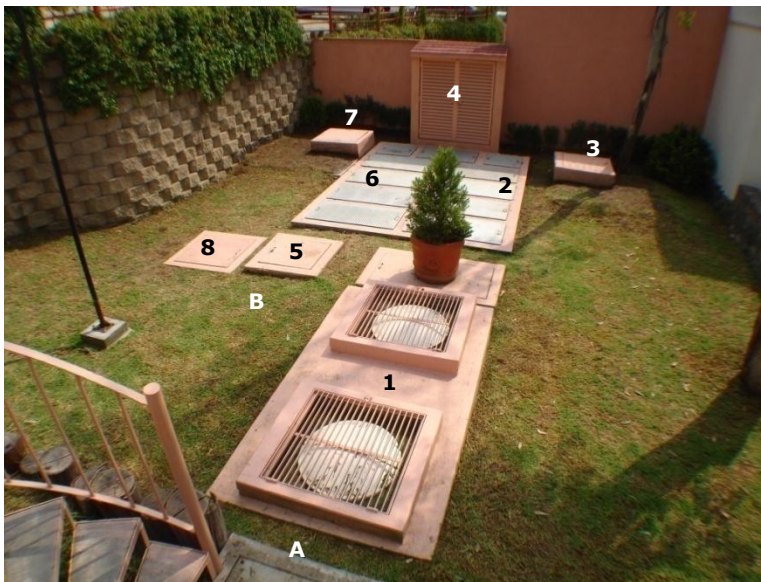
Fig.39. Sistema de tratamiento del Conjunto "Cañadas del Lago" Fuente: ©Sandra Pliego Hdz.
