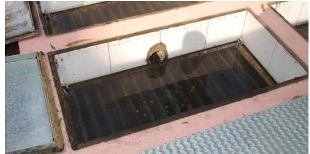
Fig.43. Tercera fase del tratamiento del Agua Residual. Fuente: ©Sandra Pliego Hdz.
