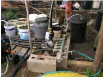
Fig.24. Sistemas eléctricos para la operación del Sistema de tratamiento.
