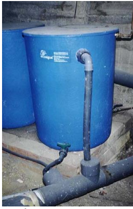
Fig.21. Depósito instalado en el sótano. Fuente: Ecoagua, Tecnología Española.
