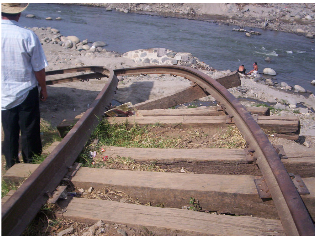
Restos del puente ferroviario en la Ciudad de Tapachula. Fotografías: Pedro Santiago Escobar. Diciembre de 2005.
