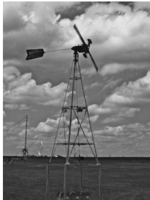
Figura B.8 Cargador eólico de baterías. Fuente: Nelson et al, 2004.
