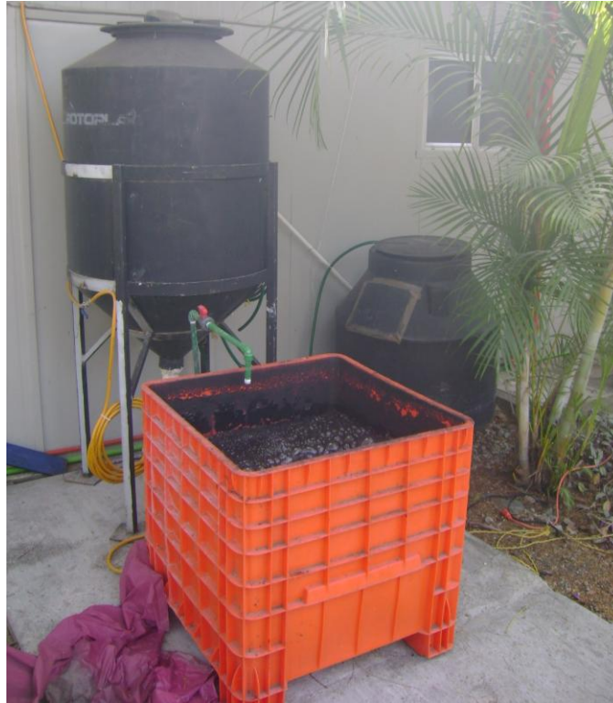
Figura 3.17. Sistema de biofiltro anaerobio de lecho sumergido y SBR
