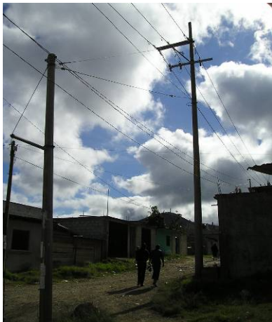
Vista del tipo de distribución del servicio de energía eléctrica, ubicado en la esquina norte del predio a utilizar.
