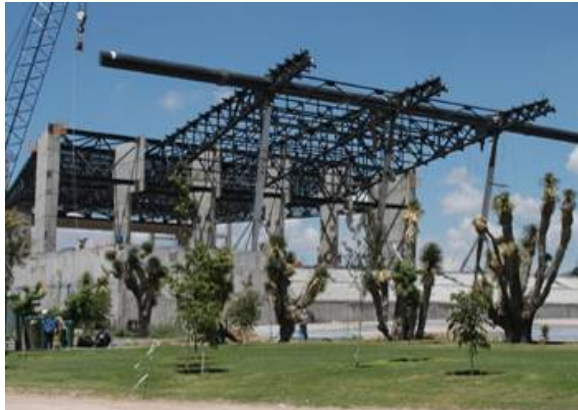
Armado de la estructura del Teatro gota de plata en el parque cultural David Ben Gurión en Pachuca Hidalgo.
