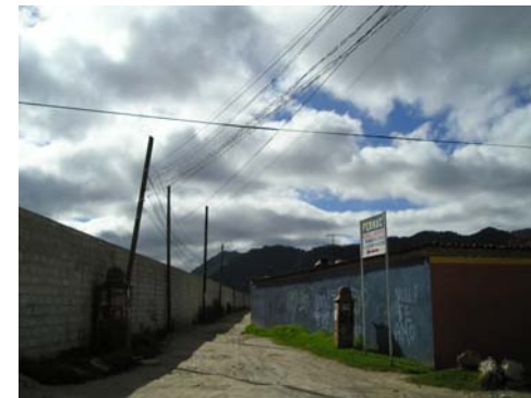
Vista de la Cerrada del Pedregal, en donde se mantienen líneas aéreas de telefonía, en muy mal estado
