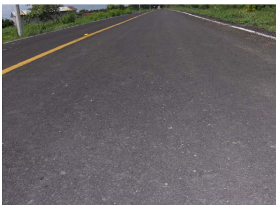
Imagen 3.4 Esta fotografía muestra el estado actual de la carpeta asfáltica.
