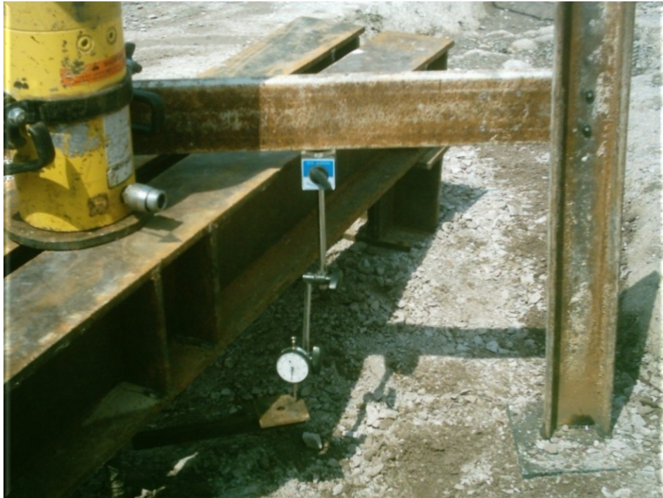
Foto IV.7.4 Marco metálico para colocar micrómetro
