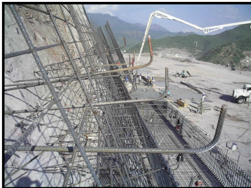
Foto IV.2.6 Ancla de gancho de 1 ½” Ø x 30m en talud para muro de contención en canal de llamada.
