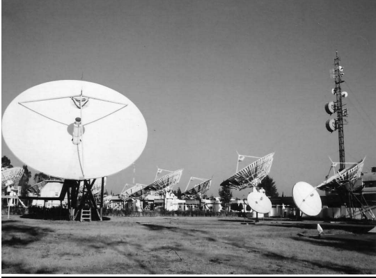
Fig. II.1 Infraestructura fija de CONTEL Iztapalapa.
