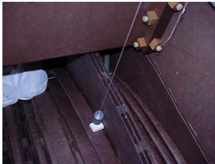
Figura 5.1d: Indicación del punto detectado sobre las bobinas del transformador (se estimó la debajo de este punto, en la parte interna de las bobinas).
