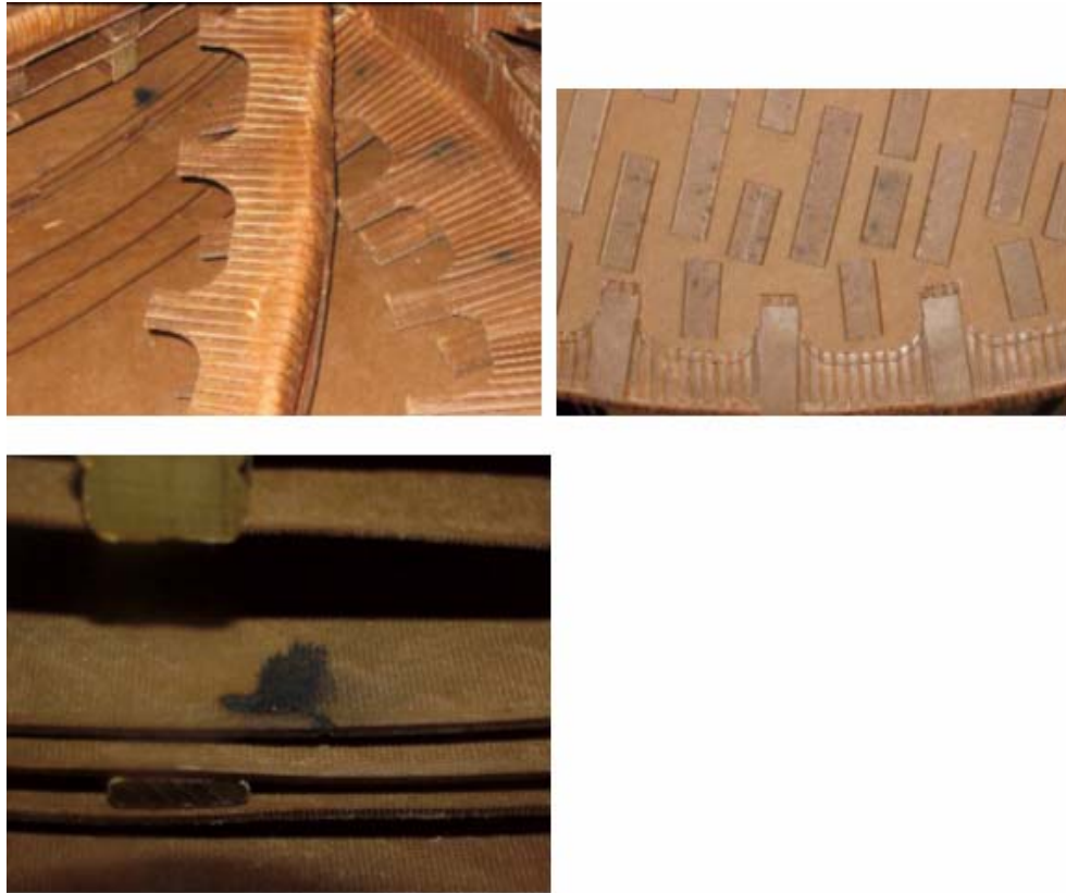
Figura 5.1e: Muestra la condición en que se encuentra el aislamiento (después de desarmar el transformador), donde se indica la existencia de la descarga (partes quemadas).
