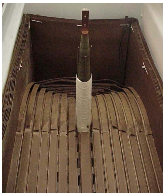
Bobina y guía de 400 KV de un reactor
