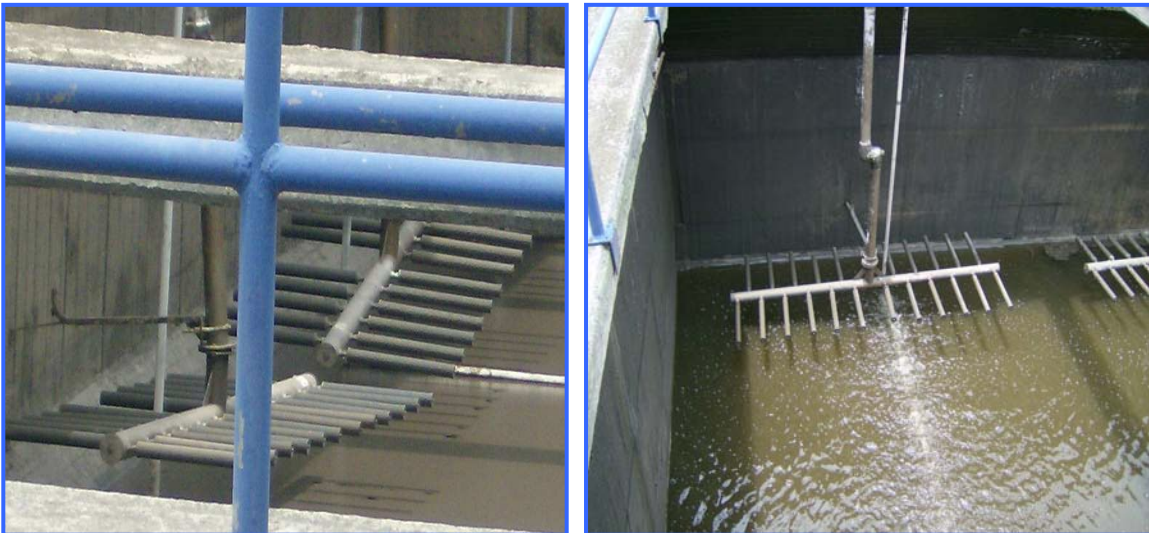
Fotografía 3.18 Tipos de Difusores que tiene el Tanque de Aireación
