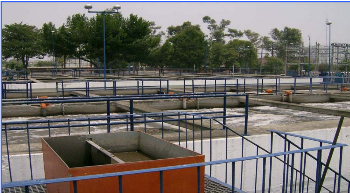
Fotografía 3.17 Vista frontal caja partidora de Lodos
