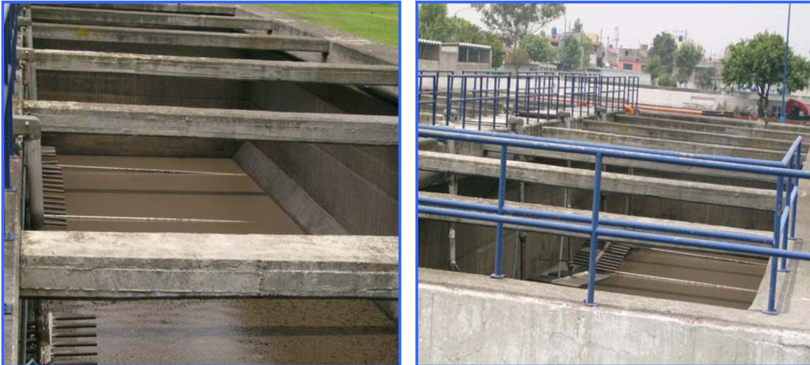
Fotografía 3.16 Tanque de Aireación en Procesamiento con los difusores
