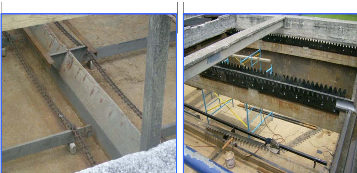
Fotografía 3.11 Perfil del Sistema de Rastras del Sedimentador Primario de la Planta
