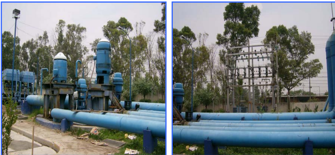
Fotografía 3.6 Cárcamo de bombeo de agua cruda a la PTAR.
