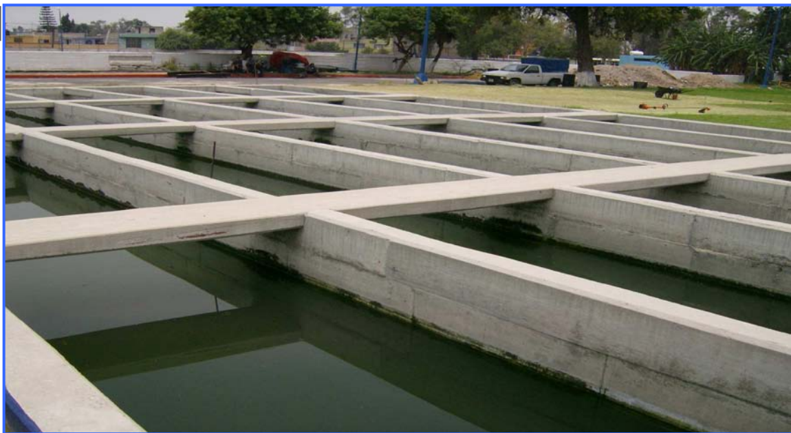
Fotografía 3.30 Laberinto de contacto de cloro
