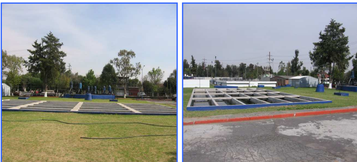
Fotografía 3.3 Laberinto de contacto de Cloro de la Planta de San Juan de Aragón
