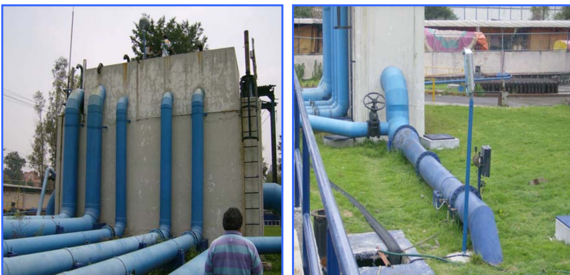
Fotografía 3.6 Tanque elevado para conducción de agua cruda a la PTAR.
