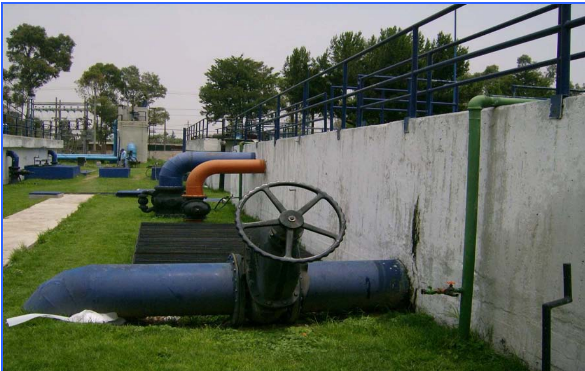
Fotografía 3.13 Entrada del Licor Mezclado en el Tanque de Aireación en la Planta
