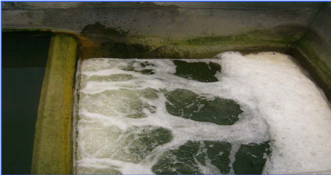
Fotografía 3.29 Tanque de contacto de cloro
