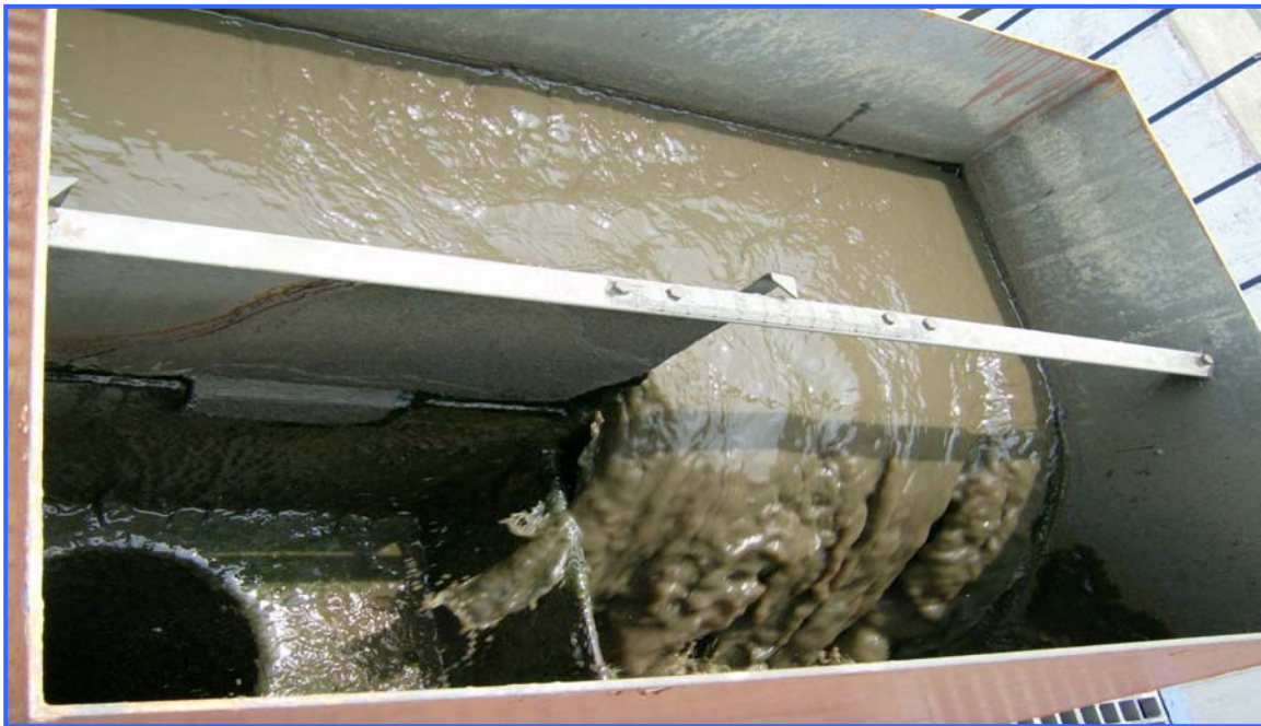
Fotografía 3.27 Caja partidora de lodos
