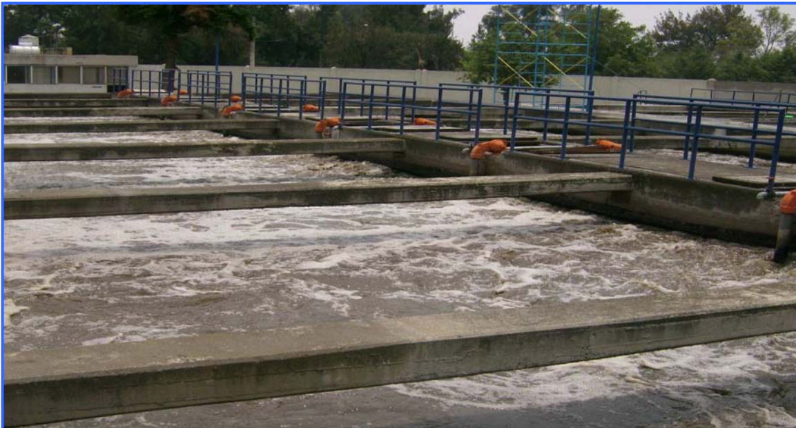
Fotografía 3.15 Tanque de Aireación en Procesamiento con los difusores
