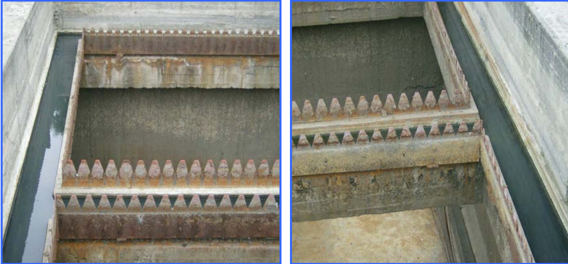
Fotografía 3.12 Sedimentador primario canaletas por donde corre el agua en la planta
