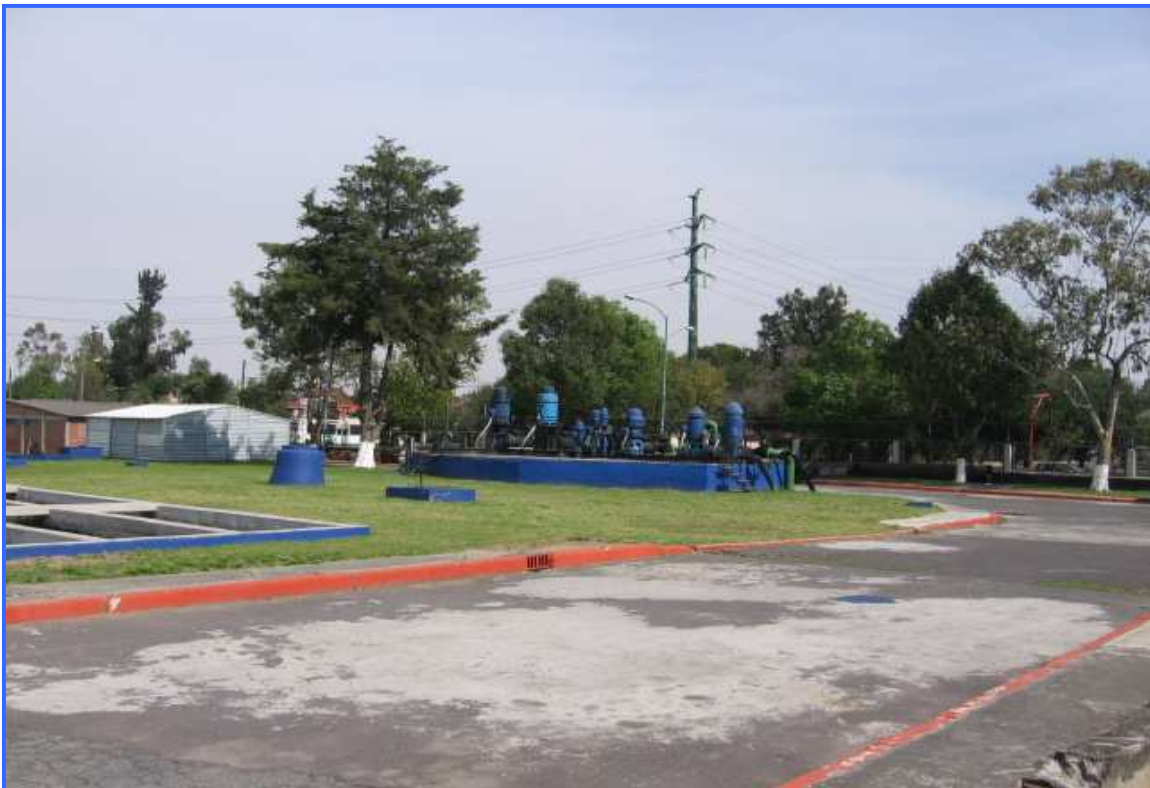
Fotografía 3.5 Bombas del Cárcamo de Agua de la Planta de Tratamiento Aragón
