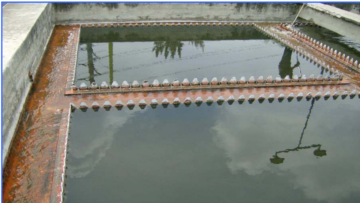
Fotografía 3.26 Agua tratada en el sedimentador secundario
