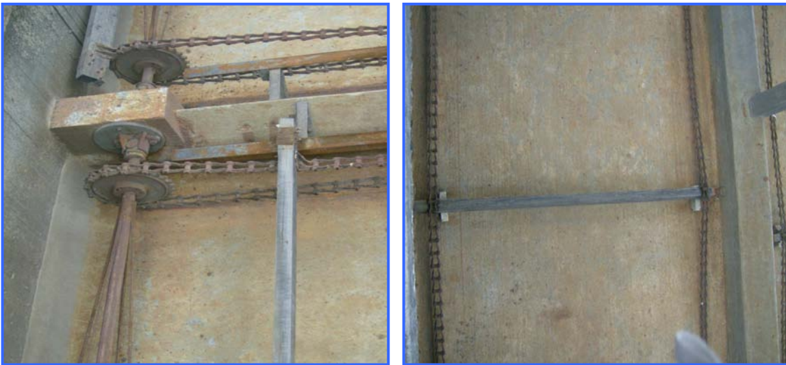
Fotografía 3.10 Sistema de Rastras del Sedimentador Primario de la Planta
