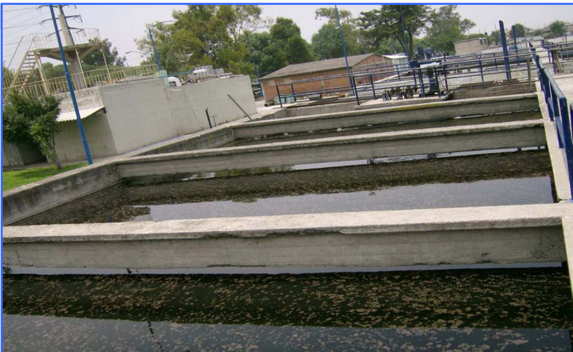
Fotografía 3.23 Agua en el tanque sedimentador secundario
