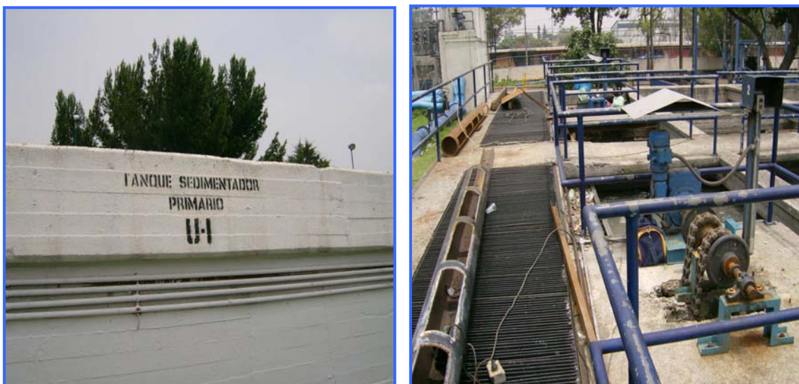
Fotografía 3.7 Tanque Sedimentador Primario de la Planta Aragón
