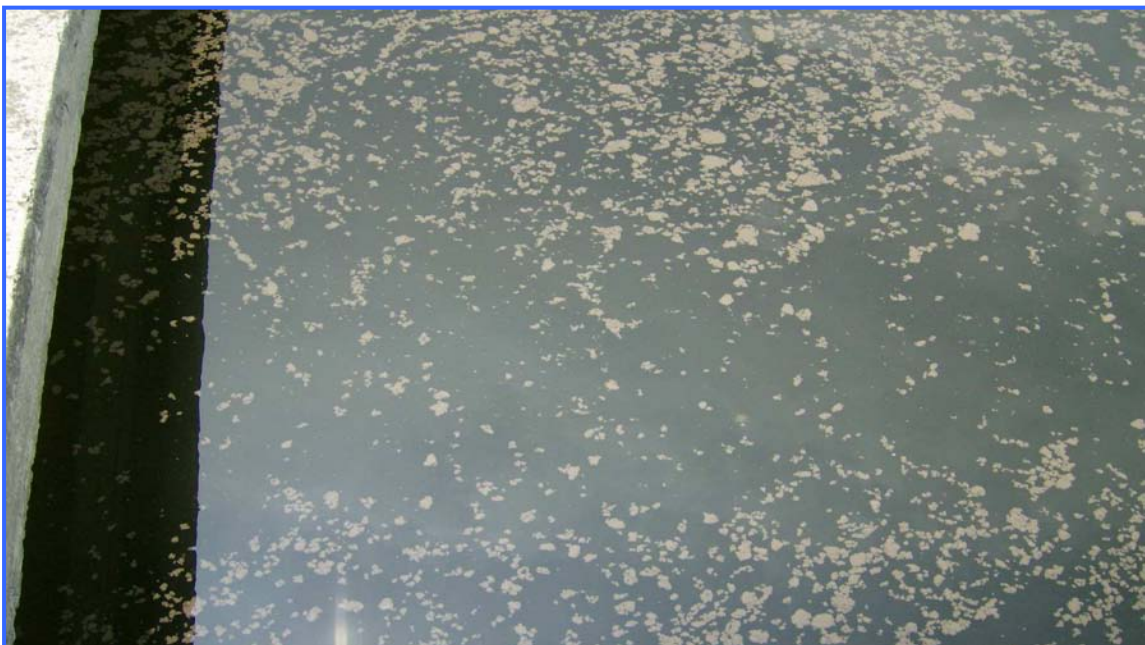
Fotografía 3.25 Agua tratada en el sedimentador secundario
