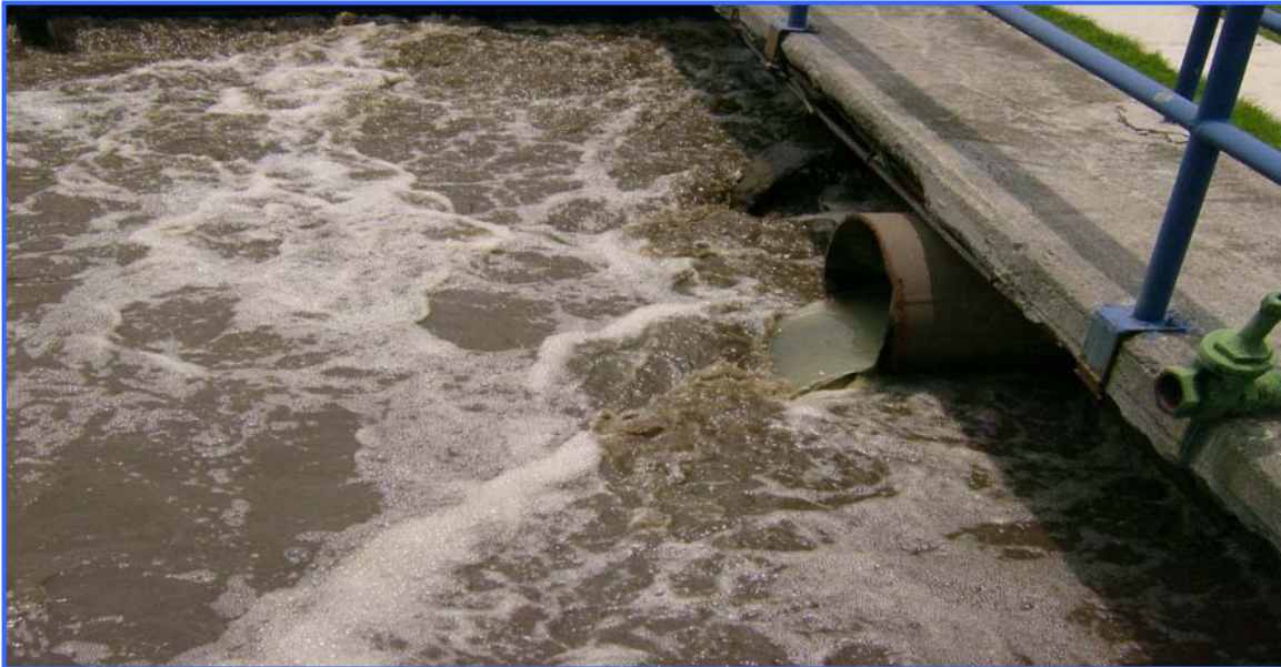
Fotografía 3.14 Entrada del Agua Residual en el Tanque de Aireación en la Planta
