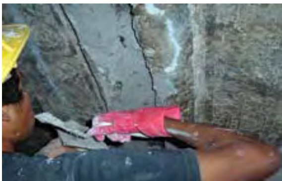
9. Aplicaciones de revestimiento en el intradós de bóvedas del convento de Tecpatán.
