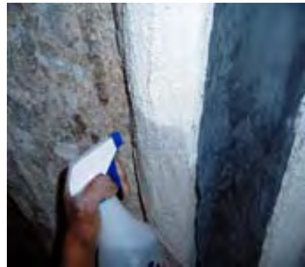
11. Aplicaciones de agua esparcida para humedecer la superficie con revestimiento a un tendido. Nervadura ubicada en el convento de Tecpatán. Foto: autor, 2006
