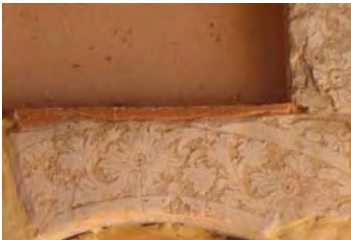
86. Ornamentación esgrafiada en muro norte. Convento de Chiapa de Corzo. Foto: autor, 2006.
