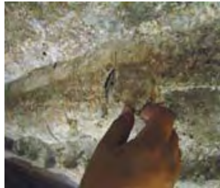
14. Desprendimiento de una pieza suelta de aplanado agrietado. Convento de Tecpatán.
