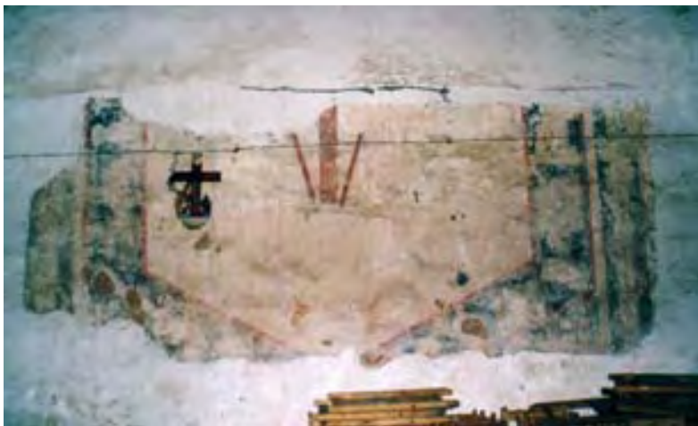
48. Vestigios de pintura mural, representan retablos. Templo de San Antonio, Tapalapa. Foto: autor, 2007
