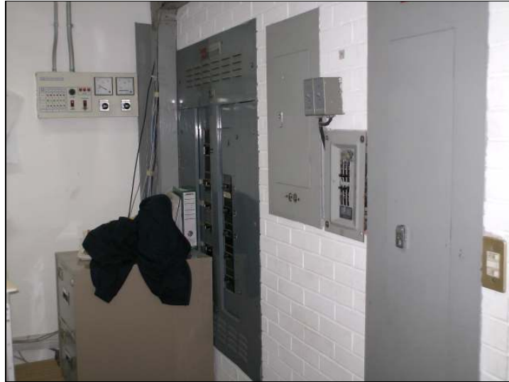
FIGURA 5.4 TABLERO PRINCIPAL DEL CENTRO DE CÓMPUTO
