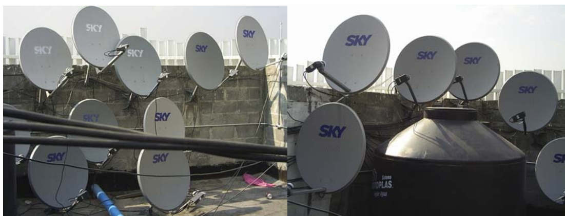
Figura 4.63 Vista de la azotea de un edificio en donde hay gran demanda de señales de televisión satelital
