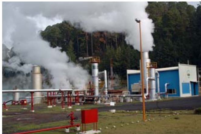
Central Geotermoelectrica Los Azufres II, Michoacán, México Fuente: http://saladeprensa.cfe.gob.mx/banco/images/portada/3/RAM_0326.jpg
