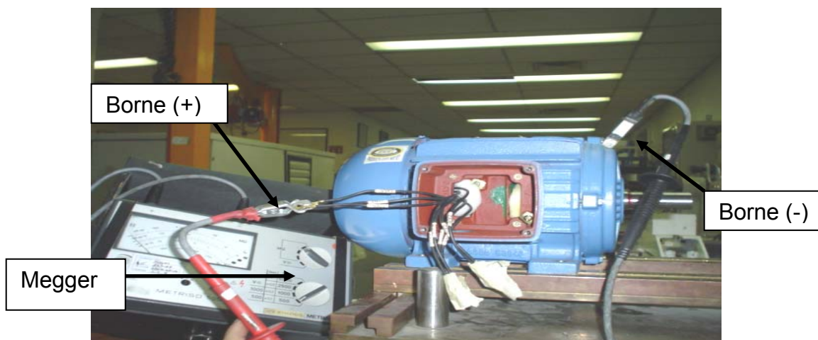
Figura 4.7 Medición de la resistencia de aislamiento al motor de 2HP
