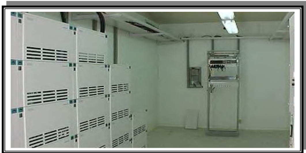
Figura 3.1 Parte del equipo de una Radio base
