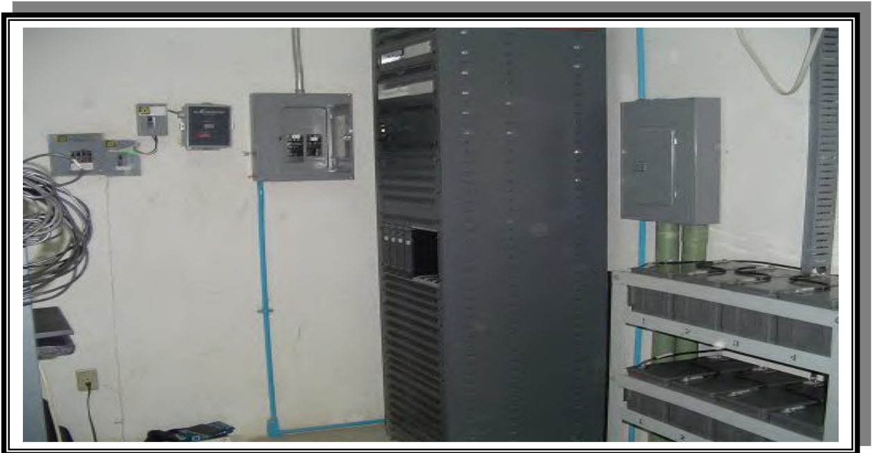
Fig. 3.12 El equipo de Fuerza y las Baterías
