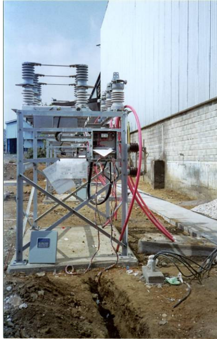
Figura C.14.- Caja de control de uno de un desconetadores cuyos cables de señalización se conectan al tablero de control. La zanja que se observa, es para colocar la canalización de dichos cables.
