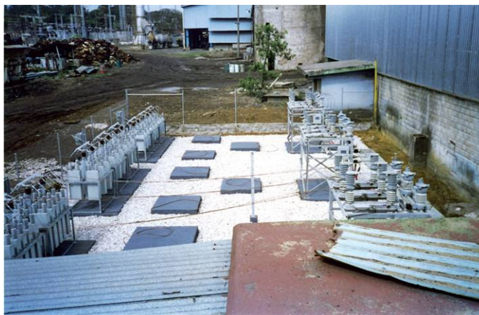
Figura C.15.- Vista izquierda del filtro (sin reactores núcleo de aire), se observa que el terreno a sido acondicionado con grava y que las cimentaciones han sido pintadas (se utilizo pintura para uso intemperie, sin ingredientes metálicos).
