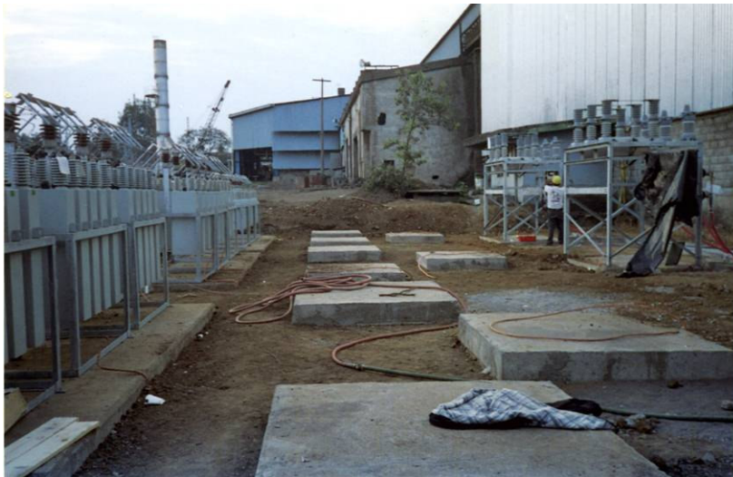
Figura C.11.- Racks (arreglos) de capacitores de las tres secciones de filtrado y desconectores de dos secciones de filtrado
