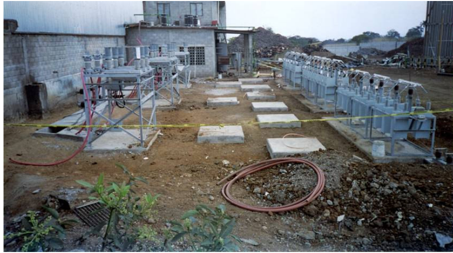
Figura C.12.- Racks de capacitores y desconectores del filtro
