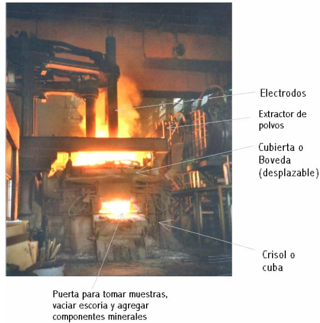
Figura 1.16.- Horno de arco eléctrico, de 27,000 kVA, 13.8 kV, 3F, durante su operación (fotografía tomada por el autor de la presente tesis, en la siderúrgica: Metaver, Córdoba Ver.)
