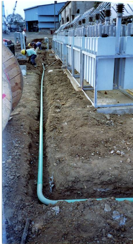
Figura C.22.- Instalación de las canalizaciones para los cables de señalización de transformadores de corriente y dispositivos de accionamiento de las cuchillas de puesta a tierra
