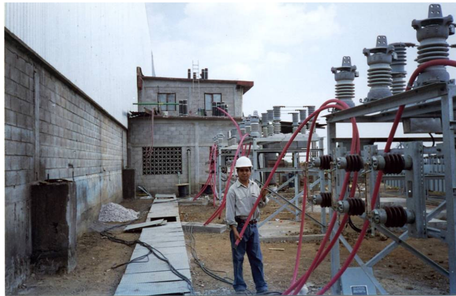
Figura C.13.- Autor de la presente tesis en la parte frontal de un desconector. Para fines prácticos, se puede decir que la parte frontal del filtro, es la parte frontal de los desconectores. Los cables color rojo conectan a los desconectores con el interruptor general, mismo que se localiza en el interior del cuarto que se observa al fondo.
