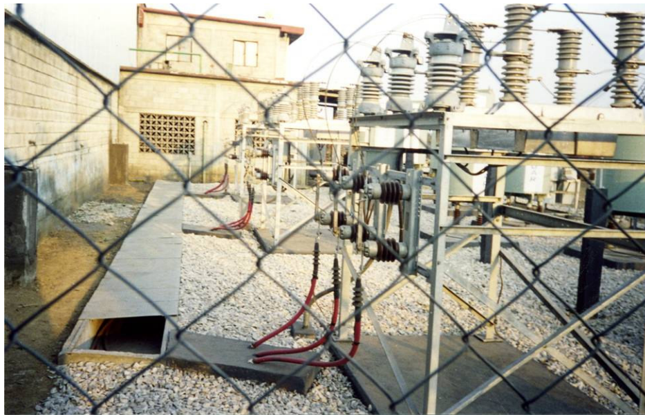
Figura C.16.- Montaje de los desconectadores terminado. Los conductores (cables color rojo) de cada sección de filtrado, se introducen a la trinchera (ducto rectangular con tapas metálicas) para ser conectados al interruptor general, localizado en el interior del cuarto del fondo.
