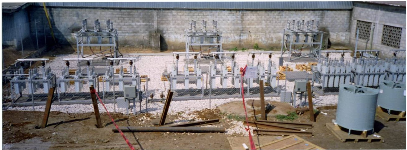
Figura C.19.- Vista posterior de los racks de capacitores, desconectadores (las cajas de madera que contienen componentes de los soportes de los reactores)
