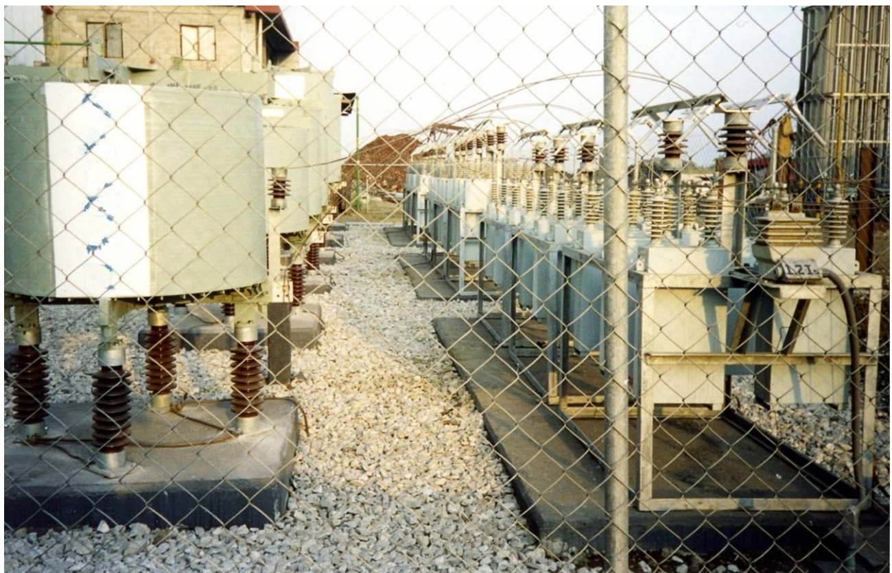
Figura C.21.- Montaje de los reactores núcleo de aires y racks de capacitores, terminados
