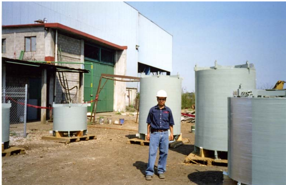
Figura C.17.- Autor de la presente tesis junto con los reactores núcleo de aire del filtro, durante el proceso desembalaje de los mismos.
