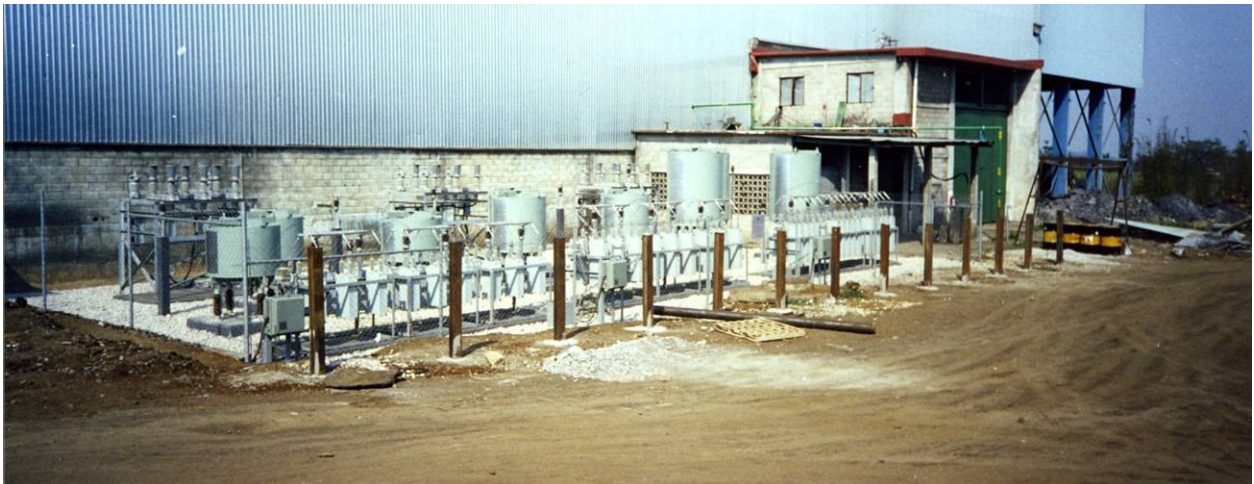
Figura C.28.- Filtro completamente ensamblado, se observa la parte posterior del filtro, ya que su parte frontal apunta hacia la pared. Para fines prácticos, la parte frontal del filtro es el punto de conexión de los cables color rojo que se muestran en la figura C.16.
