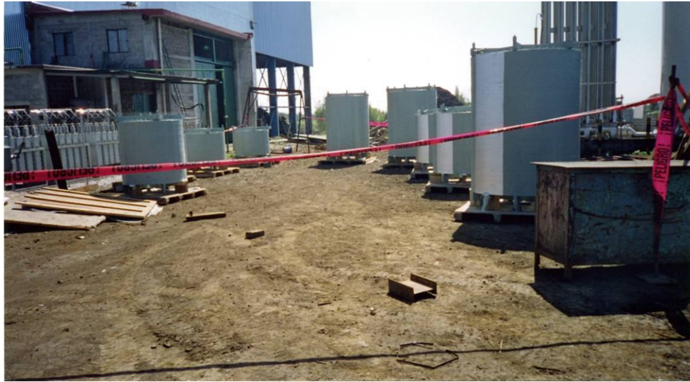
Figura C.18.- Reactores núcleo de aire
