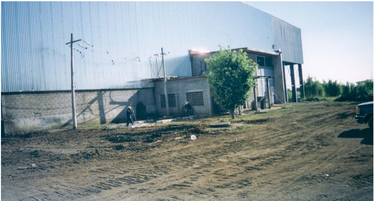
Figura C.1.- Extracción de cimentaciones correspondientes a un banco de capacitores, previamente removido. Los dos postes que se observan en la fotografía también fueron extraídos, mientras que el árbol fue transplantado.
