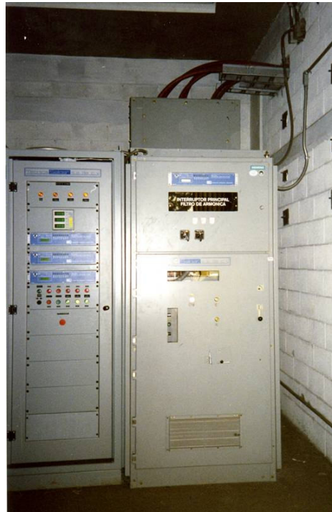
Figura C.27.- Filtro y tablero de control. Los cables que se observan en la parte superior del interruptor general (esquina superior derecha), conectan al filtro en su conjunto con el sistema eléctrico del horno (ver figura 4.14, del capítulo IV). Los cables que conectan a las secciones de filtrado (ver figura C.16), con el interruptor, llegan a éste en una canalización subterránea
