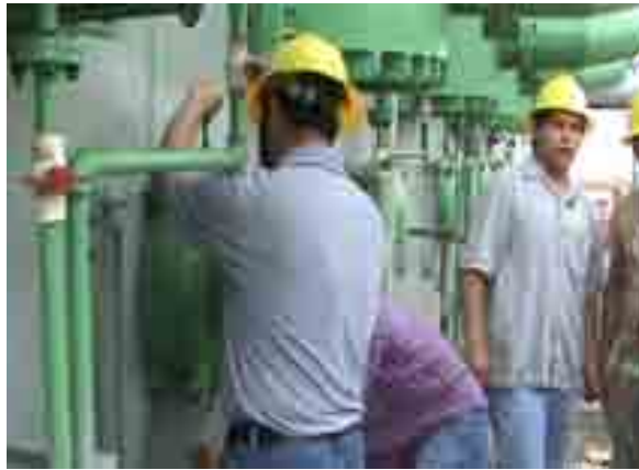
Figura 2.7 Visita a la desaladora Flash de Manzanillo [IMPULSA, 2008]
