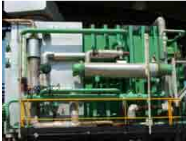
Figura 2.11 Sistema de vacío de la desaladora MED [IMPULSA, 2008]
