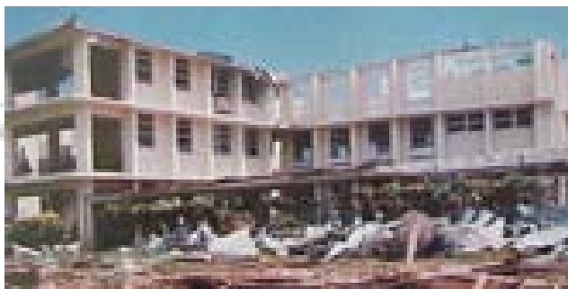
Fig. 19 (M.I.PRO.1). - Efectos del huracán Gilbert sobre el Princess Margaret Hospital, en Jamaica, en el año de 1988, al carecer de ventanas con la protección debida.
