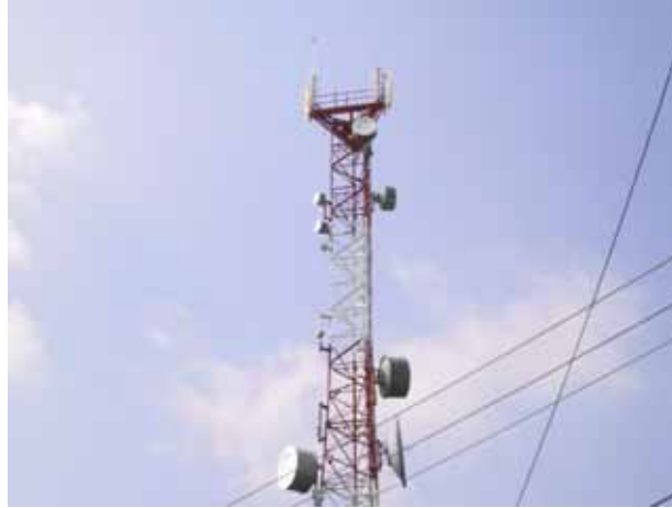
Figura IV.1.5.c. Antena de Radio Base.
