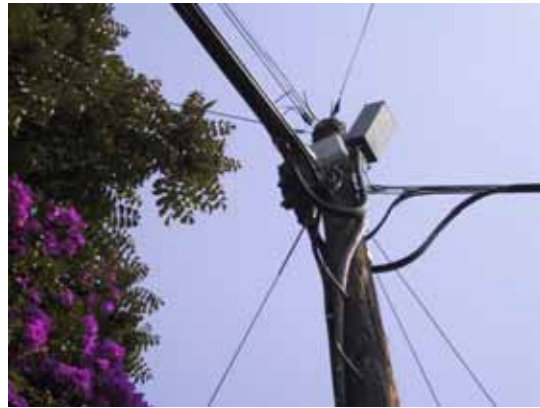
Figura III.3.2.b. Segmento primario en poste.
