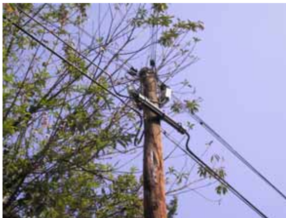
Figura III.3.4.c. Segmento de dispersión de poste a casa habitación donde se encuentra el equipo terminal.
