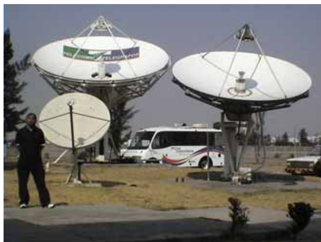
Figura II.5.2.a. Antenas para la transmisión de datos vía satélite utilizadas por Telecomm Telégrafos (Centro Operativo), Iztapalapa.
