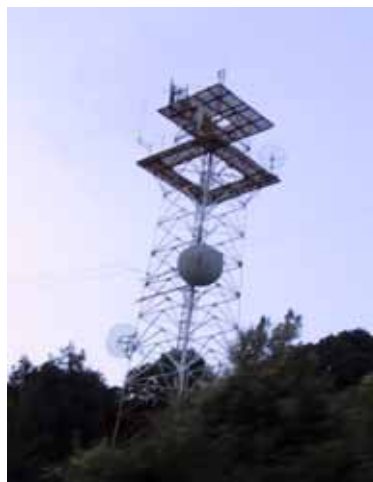
Figura II.4.3.f. Repetidor de Microondas.
