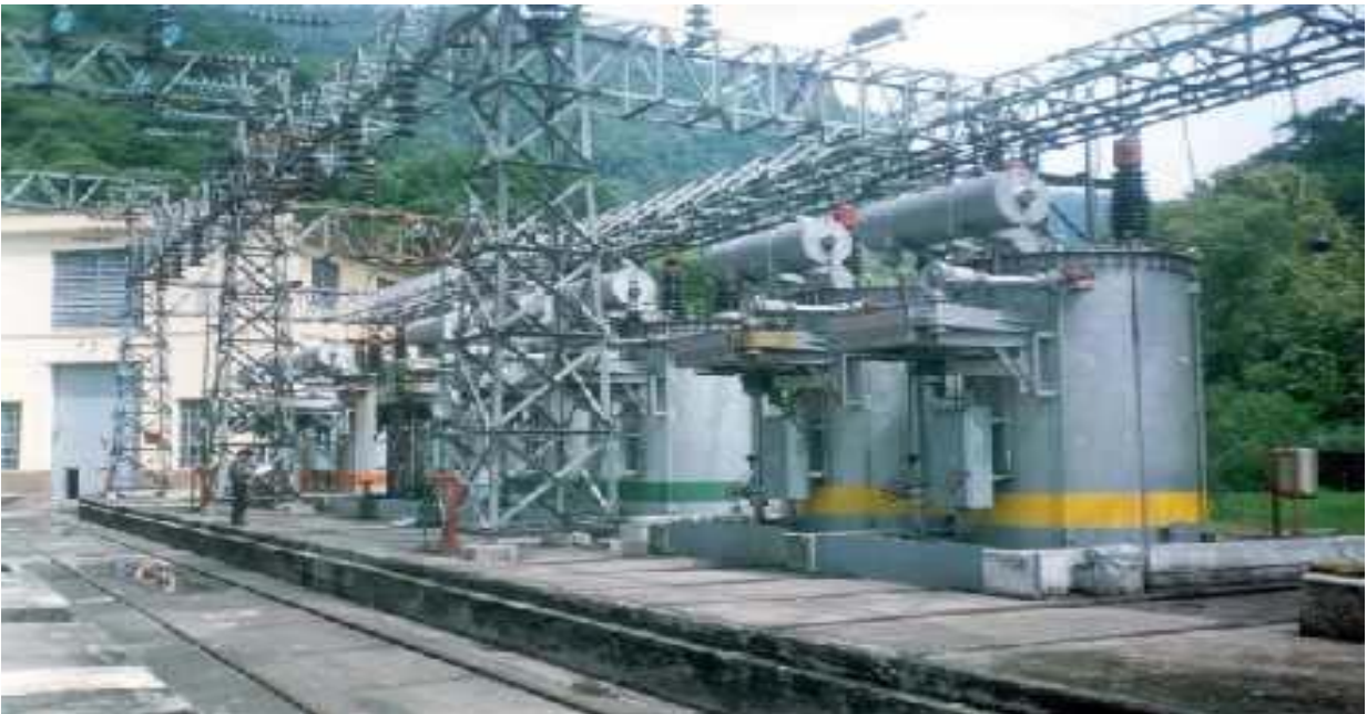
Figura I.2.- Subestación Eléctrica (Área de Transformadores)
