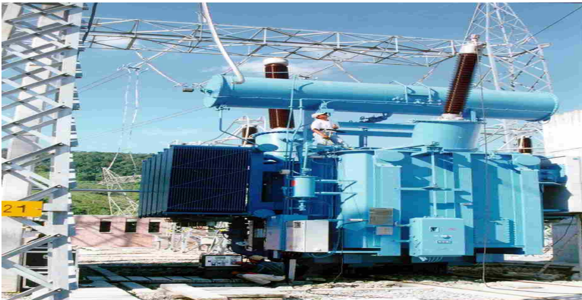
Figura I.3.- Subestación Tipo Intemperie (Transformador de Potencia)
