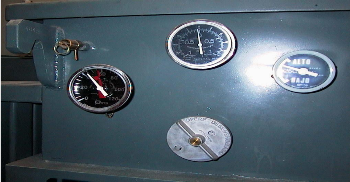
Figura II.3. Accesorios del transformador.
