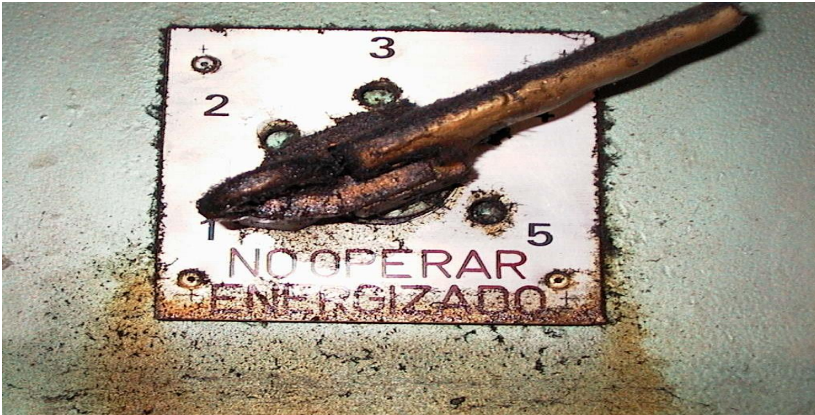
Figura II.4. Cambiador de Derivaciones
