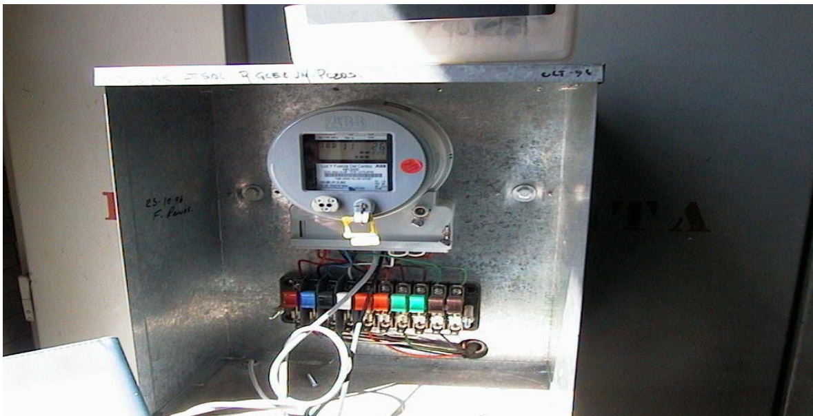
Figura II.8. Equipo de Medición.
