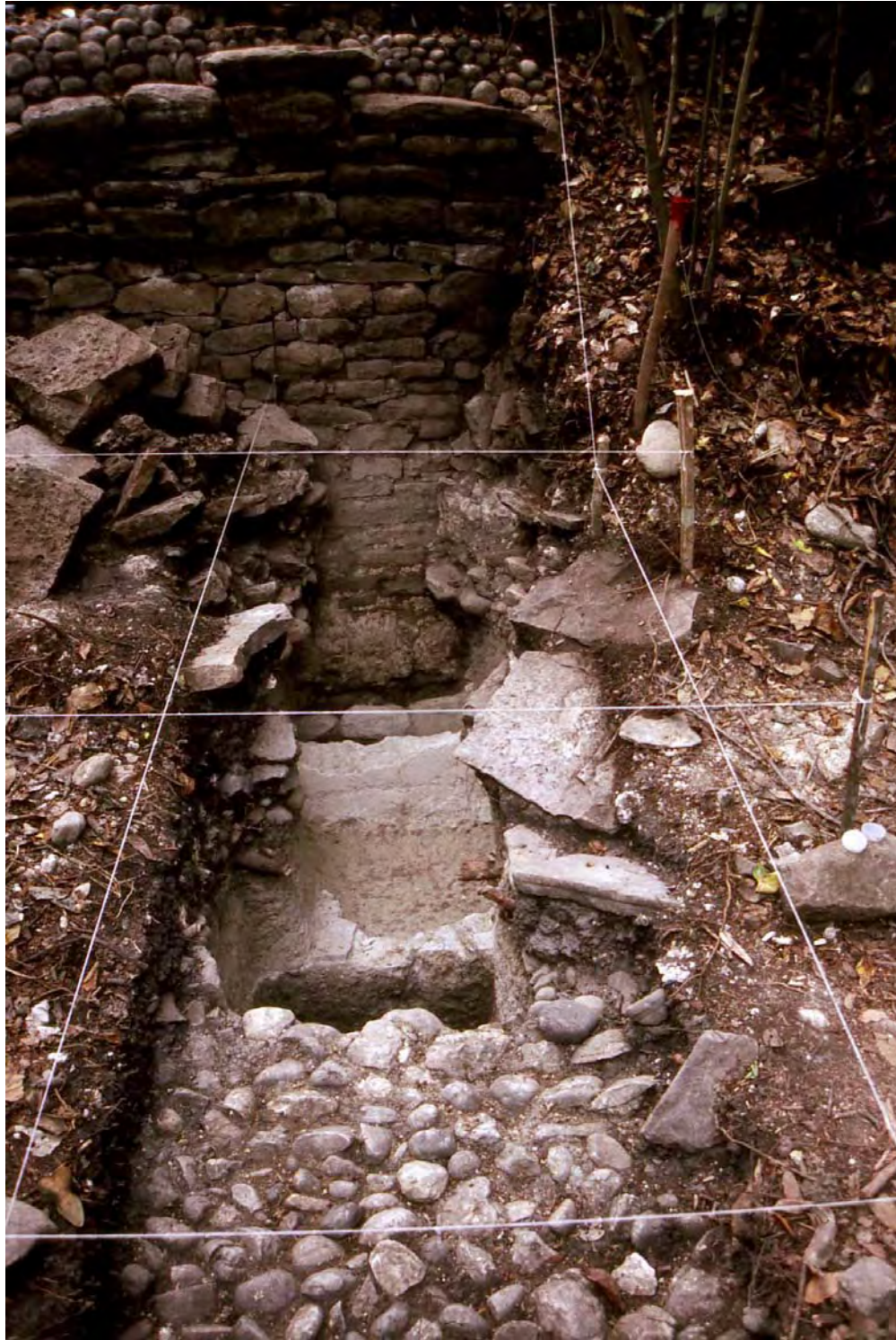
FIG. 152. Detalle del Edificio \alpha (EP5) de la Plaza del Edificio de las Columnas (ca. 900 – 1100 d.C.). El Tajín, Veracruz. Foto: Arturo Pascual Soto (2004).
