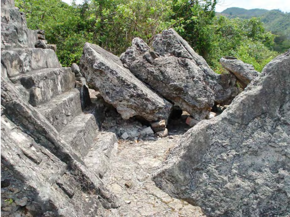
FIG. 136. Techos de mortero colapsados en el pórtico Oriente del Edificio de las Columnas. Foto: Raúl Rocha García. (2008)
