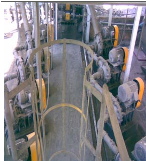
Foto 3. Cuarto de bombas del cárcamo de bombeo
