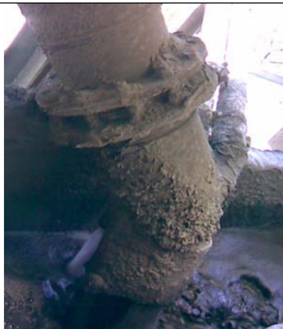
Foto 2. Homogenización de las colas del proceso de beneficio en el cárcamo de bombeo
