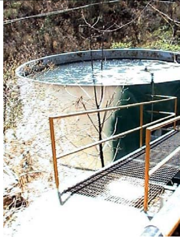
Foto 5. Tanques con agua de reproceso
