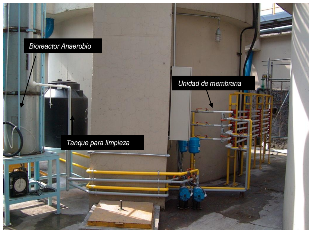
Fig 8.2 Biorreactor anaerobio tipo UASB acoplado al módulo de Membrana.
